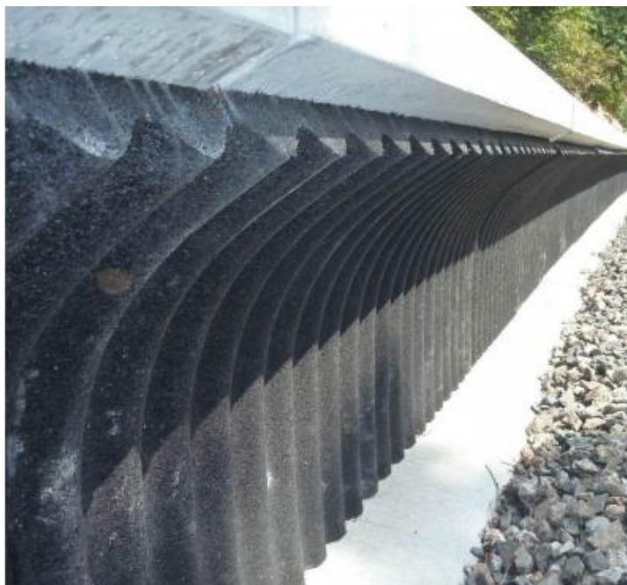
Obrázek 17: Ukázka použití na protihlukové zdi [23]
