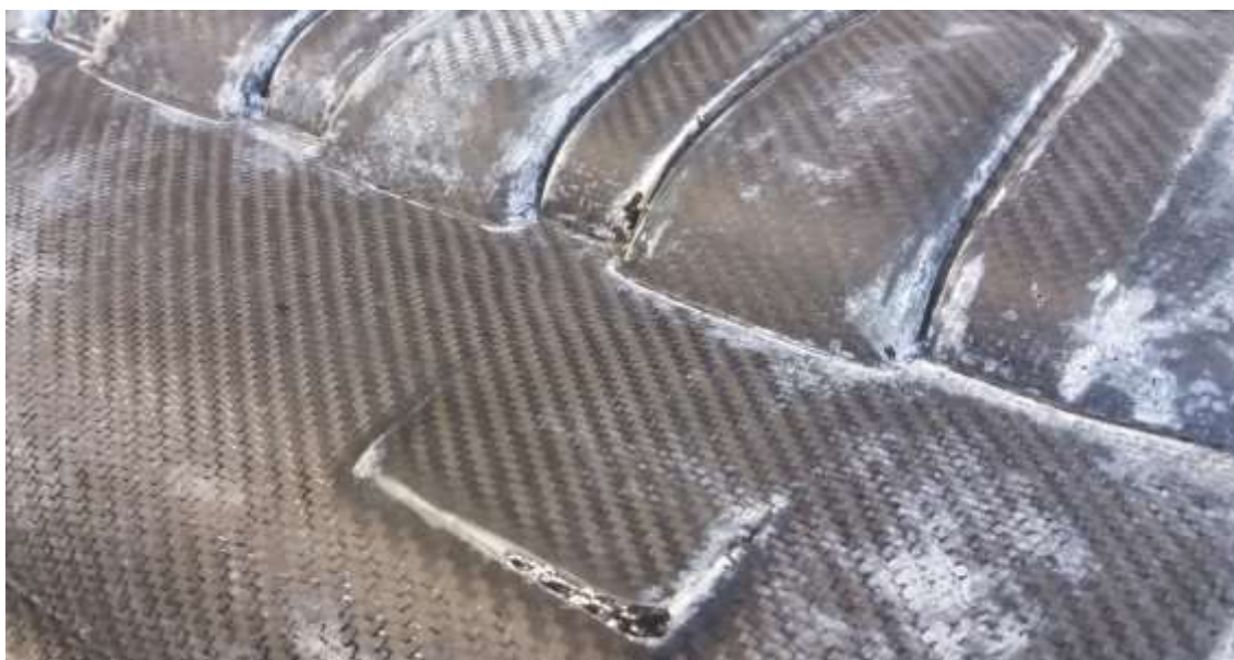
Obr. 49 Vzniklé vady po odformování – 3. způsob
