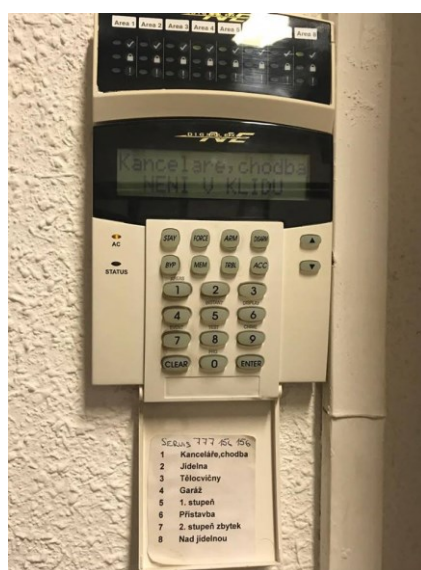
Obr. 23 Zařízení elektronického zabezpečení ze základní školy 3
