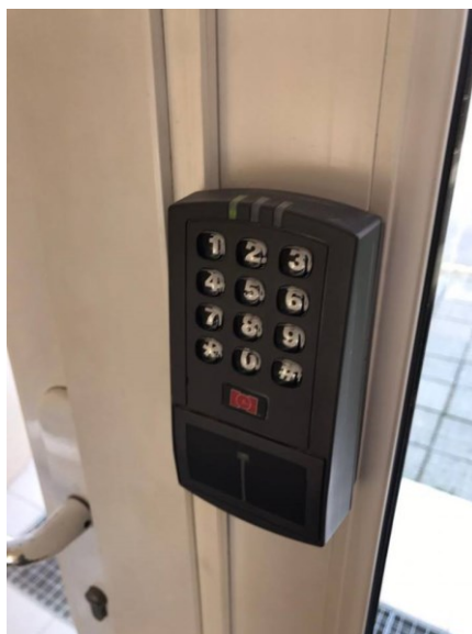
Obr. 25 Jeden z prvků elektronického zabezpečení ze základní školy 4
