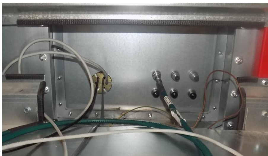
Obr. 27: Penetrační poklop uvnitř komory
