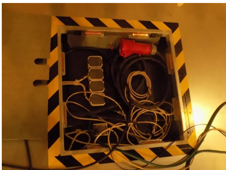
Obr. 67: Zdroj napájení umístěný pod podlahou
