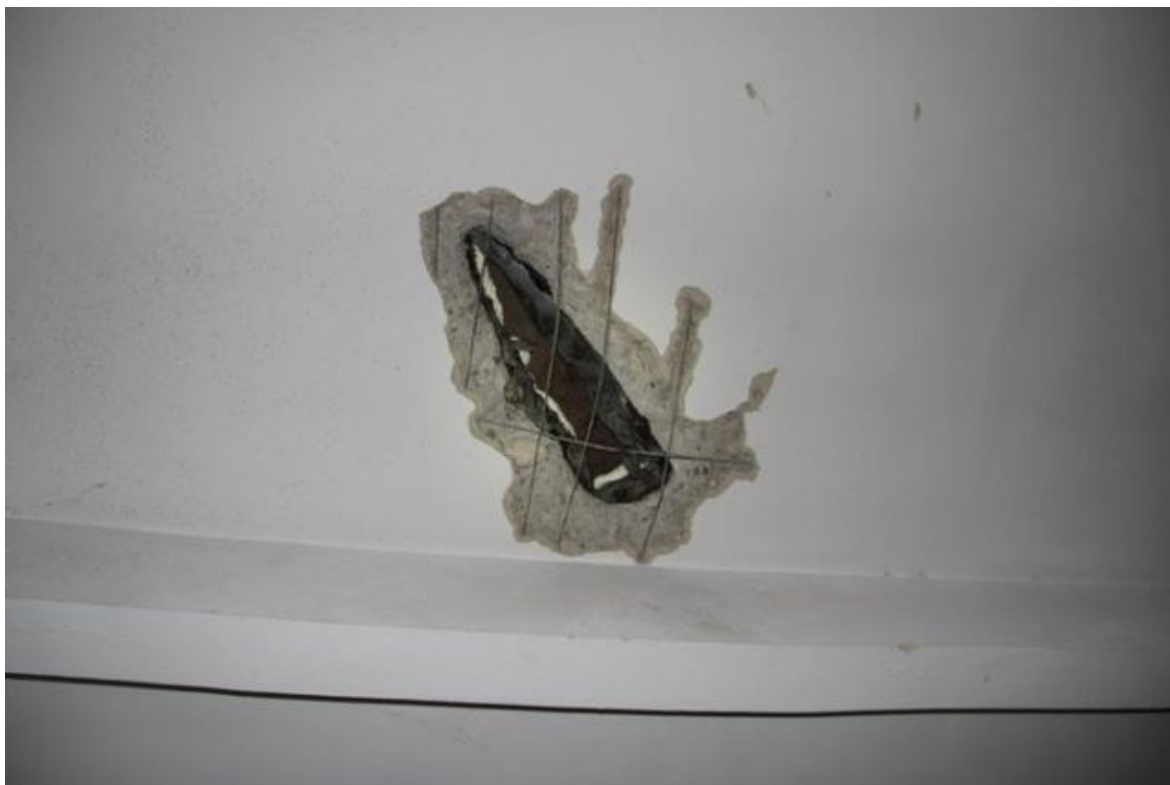
Obrázek 7: Uvzlý dělostřelecký granát ve střeše muničního skladu č. 11. Zdroj [46]
