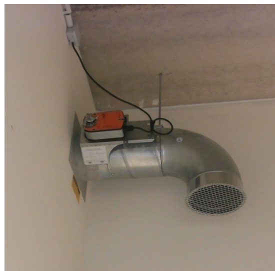
Obr. 14. Potrubí pro odvětrávání s požární klapkou a vývodem u stropu [Zdroj: vlastní]
