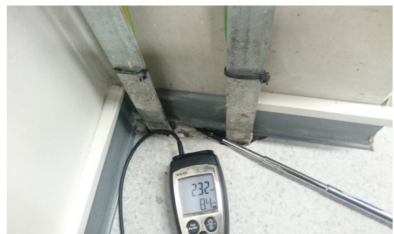
Obr. 31. Netěsnost č. 13 – Prostup do podlahy [Zdroj: vlastní]
