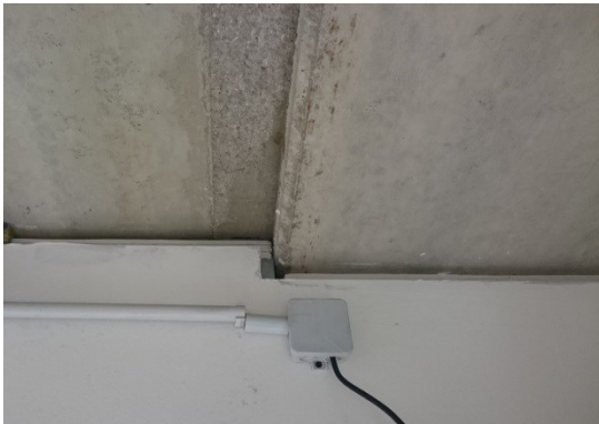
Obr. 26. Netěsnost č. 8 – Mezera mezi stropem a příčkou [Zdroj: vlastní]
