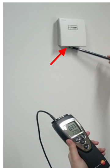
Obr. 33. Netěsnost č. 15 – Pod elektroinstalační krabicí [Zdroj: vlastní]
