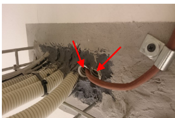
Obr. 21. Netěsnost č. 3 – Prostupy husích krků, kabelů elektroinstalace, kabelové lávky; požární ucpávka [Zdroj: vlastní]
