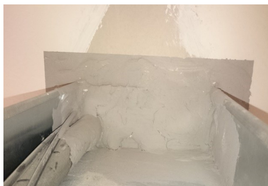
Obr. 20. Netěsnost č. 2 - Prostupy kabelů elektroinstalace [Zdroj: vlastní]
