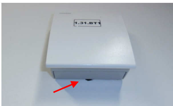
Obr. 42. Netěsnost č. 15 – Pod elektroinstalační krabicí [Zdroj: vlastní]
