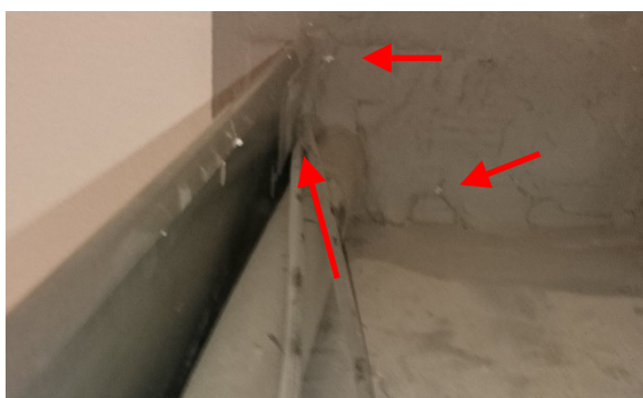
Obr. 40. Netěsnost č. 2 – Prostupy kabelů elektroinstalace a netěsná požární ucpávka [Zdroj: vlastní]
