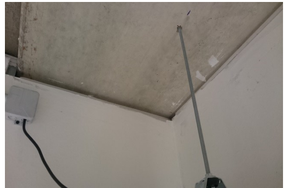
Obr. 27. Netěsnost č. 9 – Mezera mezi stropem a příčkou [Zdroj: vlastní]
