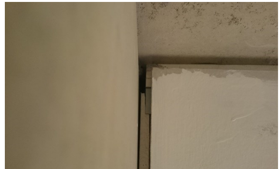
Obr. 29. Netěsnost č. 11 - Mezera mezi stropem a příčkou [Zdroj: vlastní]
