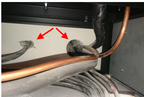
Obr. 19. Netěsnost č. 1 - Prostupy kabelů elektroinstalace [Zdroj: vlastní]
