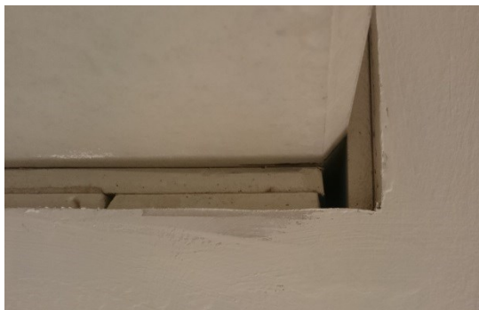
Obr. 28. Netěsnost č. 10 - Mezera mezi stropem a příčkou [Zdroj: vlastní]
