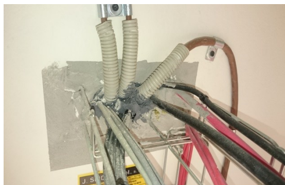
Obr. 41. Netěsnost č. 4 – Prostupy husích krků, kabelů elektroinstalace a kabelové lávky [Zdroj: vlastní]
