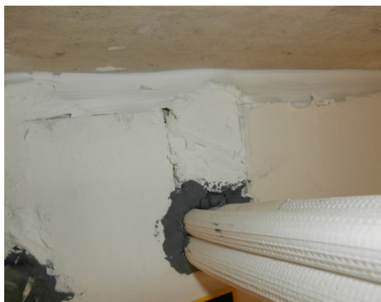
Obr. 44. Málo zatěsněný vstup [Zdroj: vlastní]
