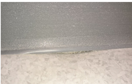
Obr. 30. Netěsnost č. 12 – Pod podlahovou lištou [Zdroj: vlastní]
