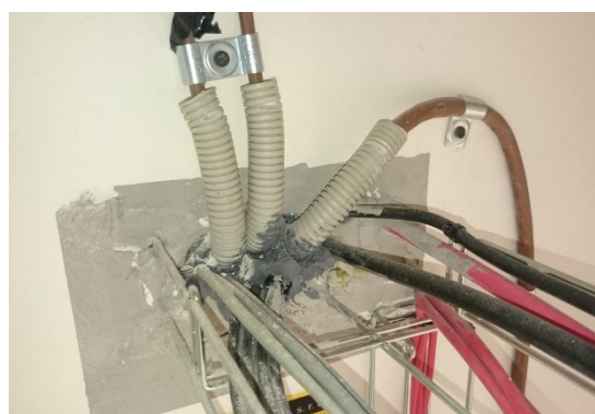
Obr. 22. Netěsnost č. 4 – Prostupy husích krků, kabelů elektroinstalace a kabelové lávky [Zdroj: vlastní]
