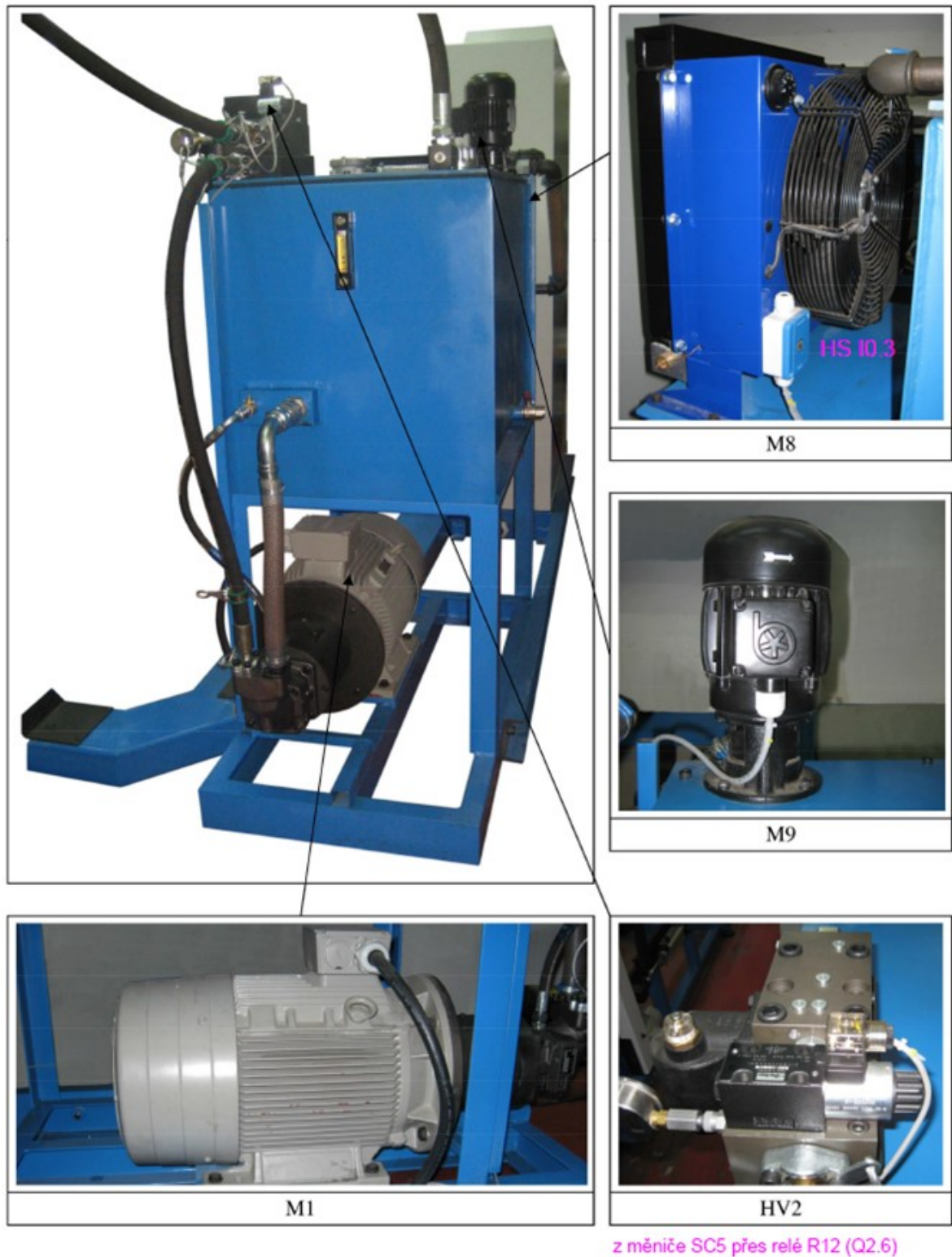
Obr. 63 Dělicí centrum – Hydraulický agregát – Umístění prvků automatizace
