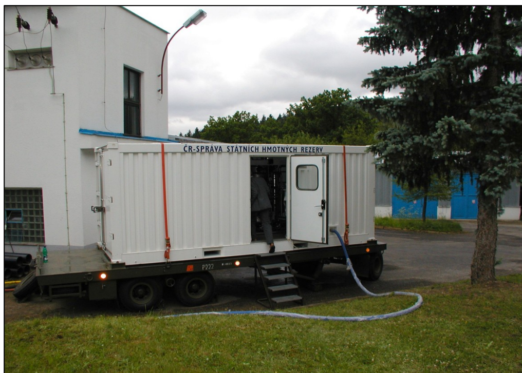
Obr. 21. Mobilní úpravna vody po dobu oprav hráze (zdroj: Oddělení krizového řízení a bezpečnosti Odboru hejtmana Kraje Vysočina)
