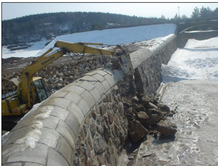
Obr. 20. Oprava těsnícího jádra VD Mostišť (zdroj: Oddělení krizového řízení a bezpečnosti Odboru hejtmána Kraje Vysočina)
