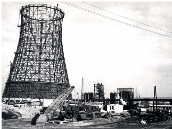
Obr. 2. Chladicí věž elektrárny [23]
