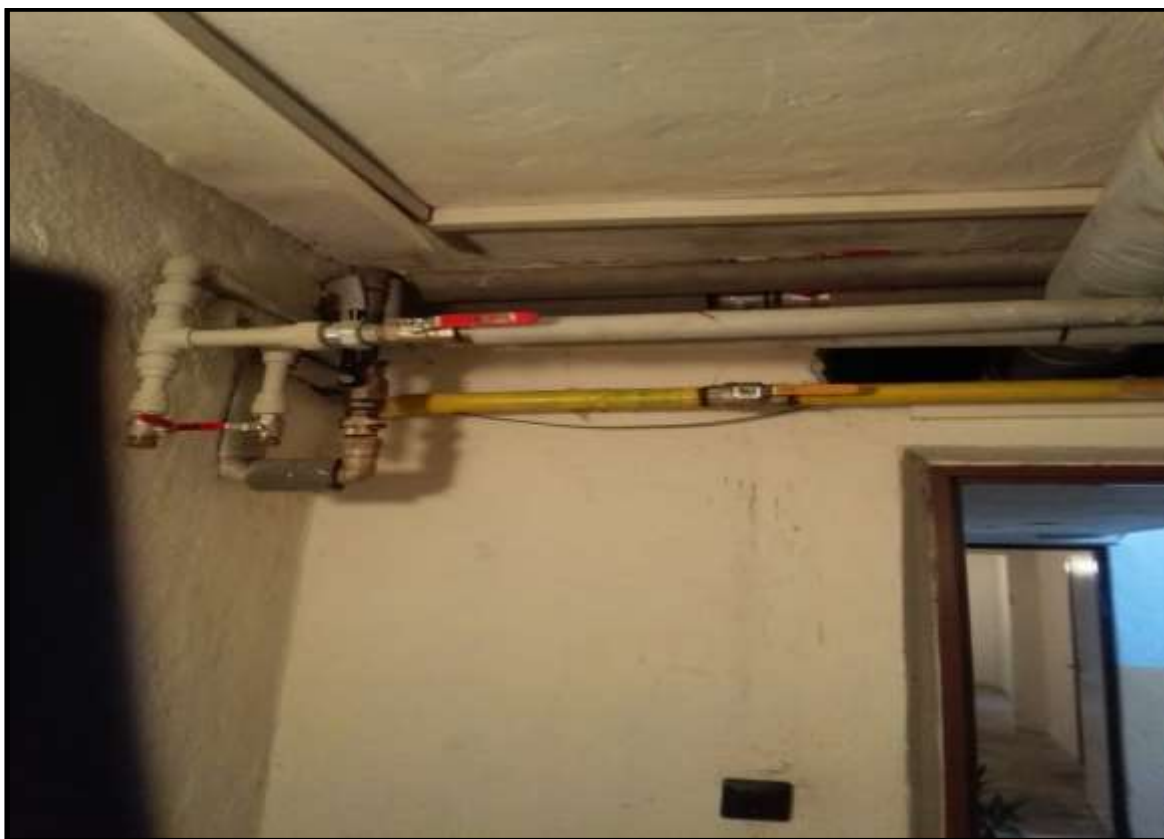
Hlavní uzávěr vody, plynu a vody do topné soustavy v domě konstrukční soustavy G 57, řadová sekce. Adresa Průmyslová 912. Dům má nadzemní sklepní prostory.
