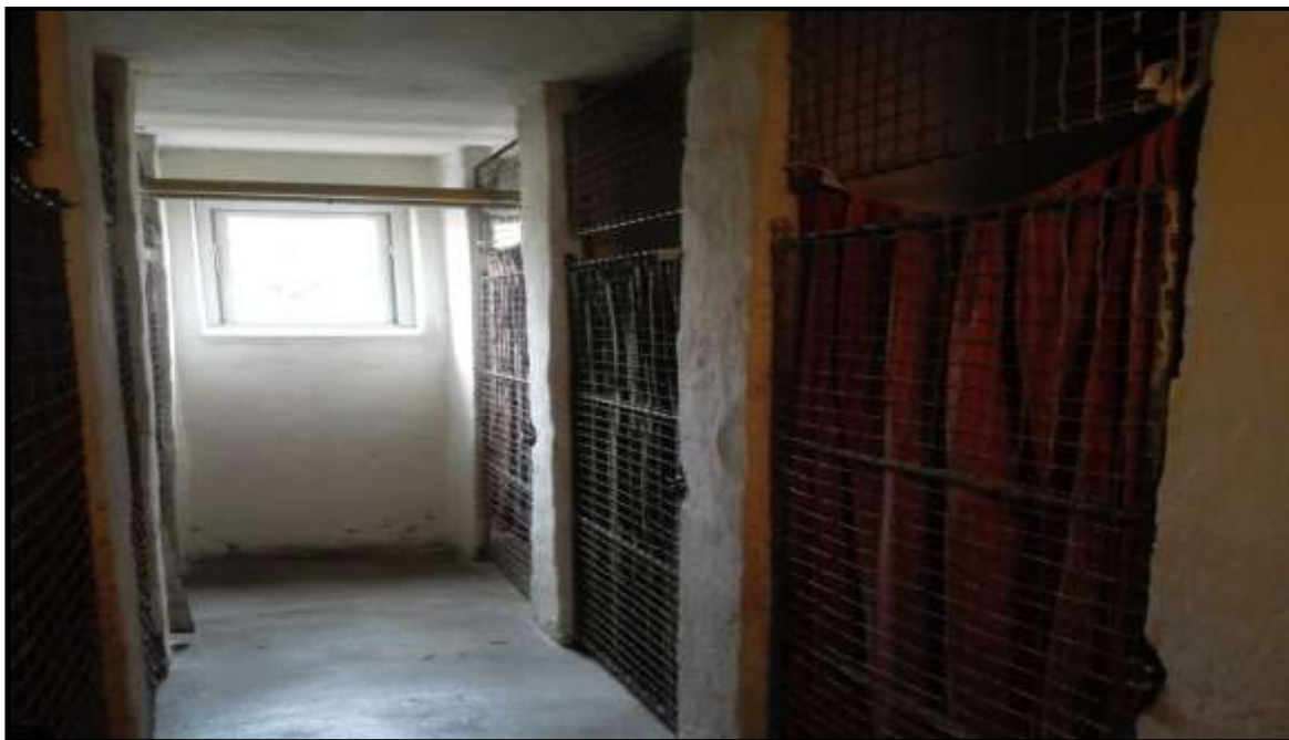
Klecové koje v domě konstrukční soustavy G 57, řadová sekce. Adresa Průmyslová 912. Dům má nadzemní sklepní prostory.
