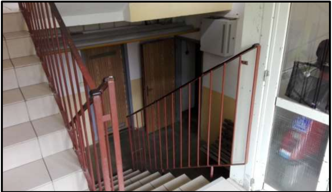
Pohled z mezipatra do prostorů sklepních prostor a výtahové šachty. Panelový dům konstrukční soustavy OP1.11, adresa Lomená 887. Dům má ze dvou třetin zapuštěný sklep.
