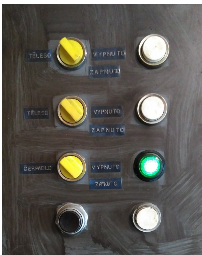
Obr. 5.3 Dveře rozvaděče kotelny
