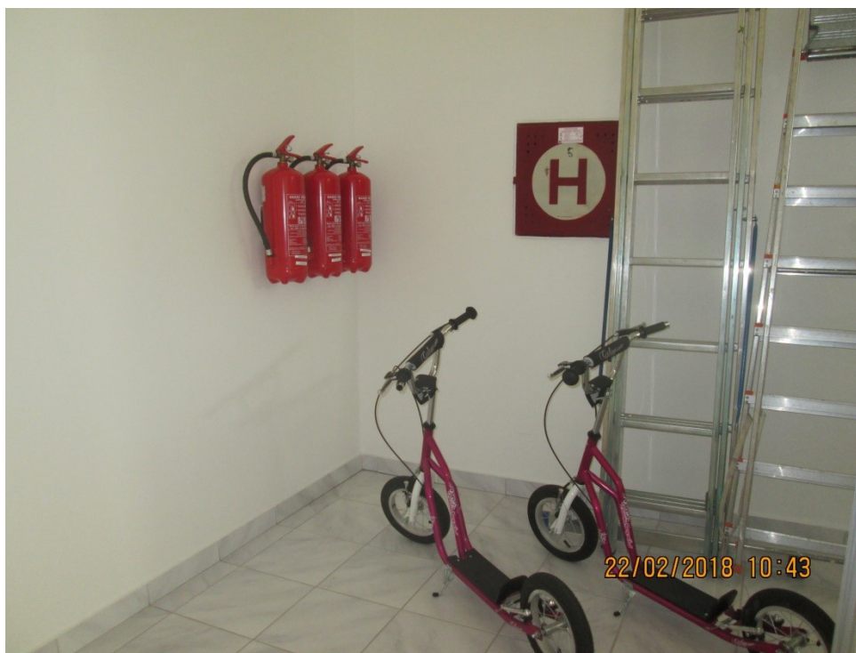
Obr. 16: Umístění hasicích přístrojů.[39]
