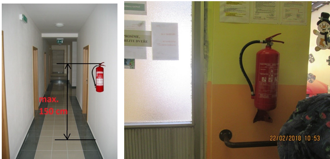
Obr. 17: Umístění hasicího přístroje [32], (vpravo) - umístění ve škole.
