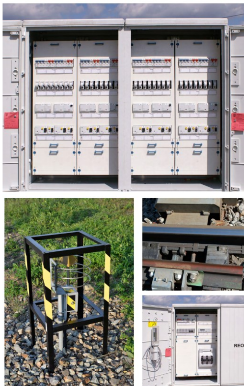
Obr. 5 - Elektrický ohřev výhybek [11]
