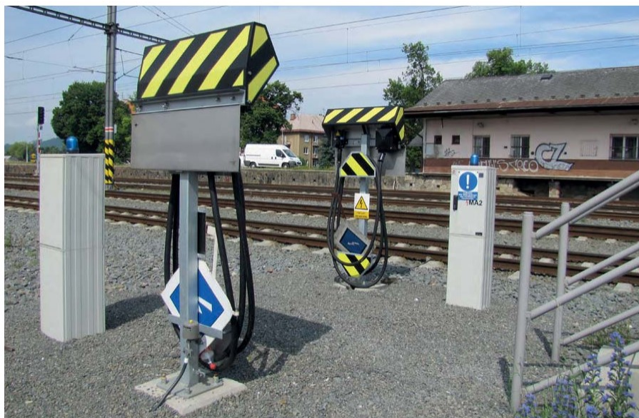
Obr. 7 - Elektrické předtápěcí zařízení v železniční stanici [43]
