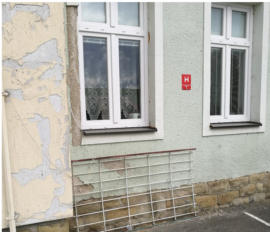
Obr. 23 – Nezabezpečená okna prodejních přepážek [autor]
