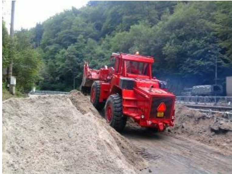
Obrázek 11 Obec Hřensko, odvoz zprůjezdění cesty, povodně 2010 [zdroj:19]
