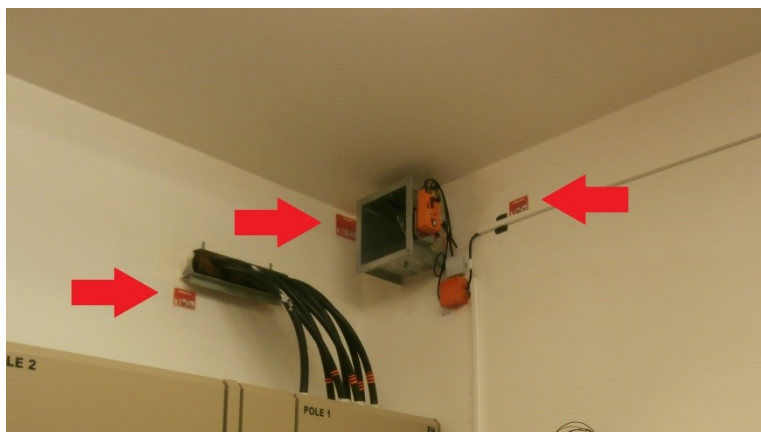
Obr. 13 Štítky označující požární ucpávky [Vlastní]
