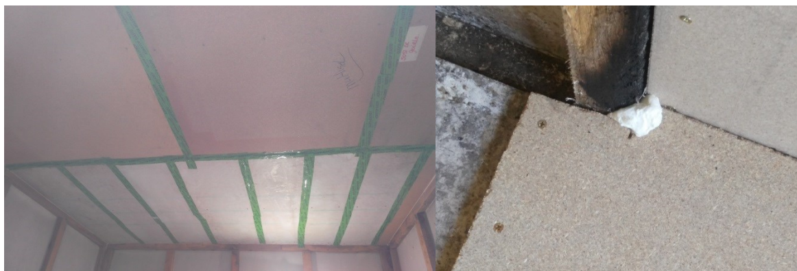
Obr. 27 Utěsnění stropu a netěsnosti mezi deskou a ohořelým místem [Vlastní]
