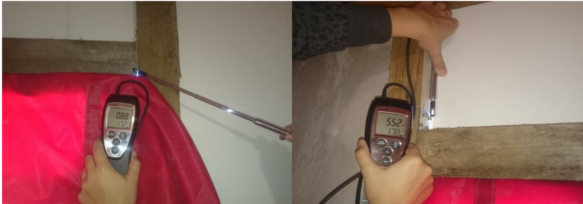
Obr. 24 Vlevo na obrázku je škvíra mezi trámky konstrukce nad dveřmi a vpravo škvíra mezi trámek konstrukce a deskou nad dveřmi [Vlastní]
