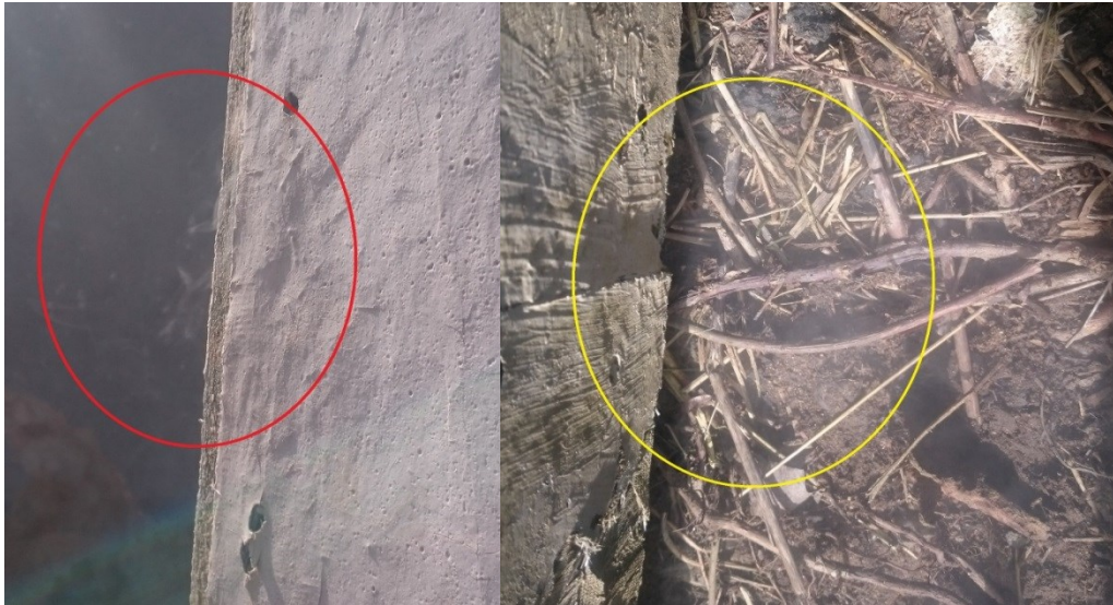
Obr. 34 Netěsnosti ověřené pomocí kouřového generátoru [Vlastní]
