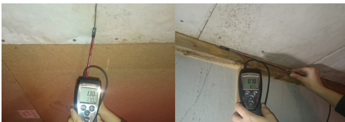
Obr. 22 Vlevo na obrázku je netěsnost spáry mezi jednotlivými deskami a vpravo netěsnost spáry mezi stropem a konstrukcí chráněného prostoru [Vlastní]
