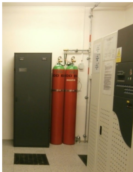
Obr. 3 Zásobníky s hasivem INERGEN umístěné v chráněném prostoru [Vlastní]
