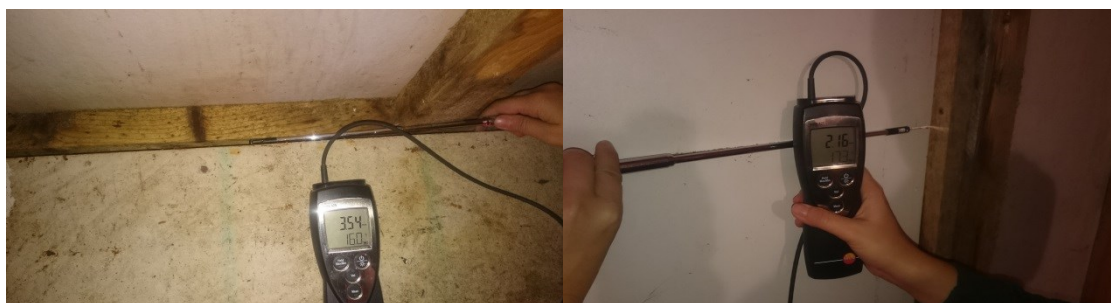
Obr. 23 Vlevo je zobrazena netěsnost mezi podlahou a konstrukcí a vpravo je zobrazena netěsnost mezi deskami vedle vstupu [Vlastní]
