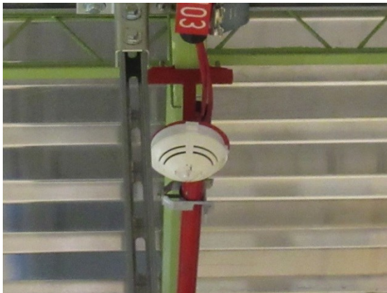
Obr. 4 Požární hlásič [Vlastní]
