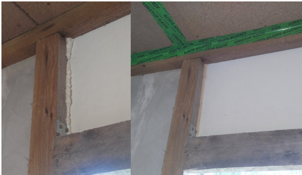
Obr. 28 Vlevo na obrázku je utěsněná netěsnost pomocí stavební pěny a vpravo je dotěsněná netěsnost pomocí těsnicího tmelu [Vlastní]
