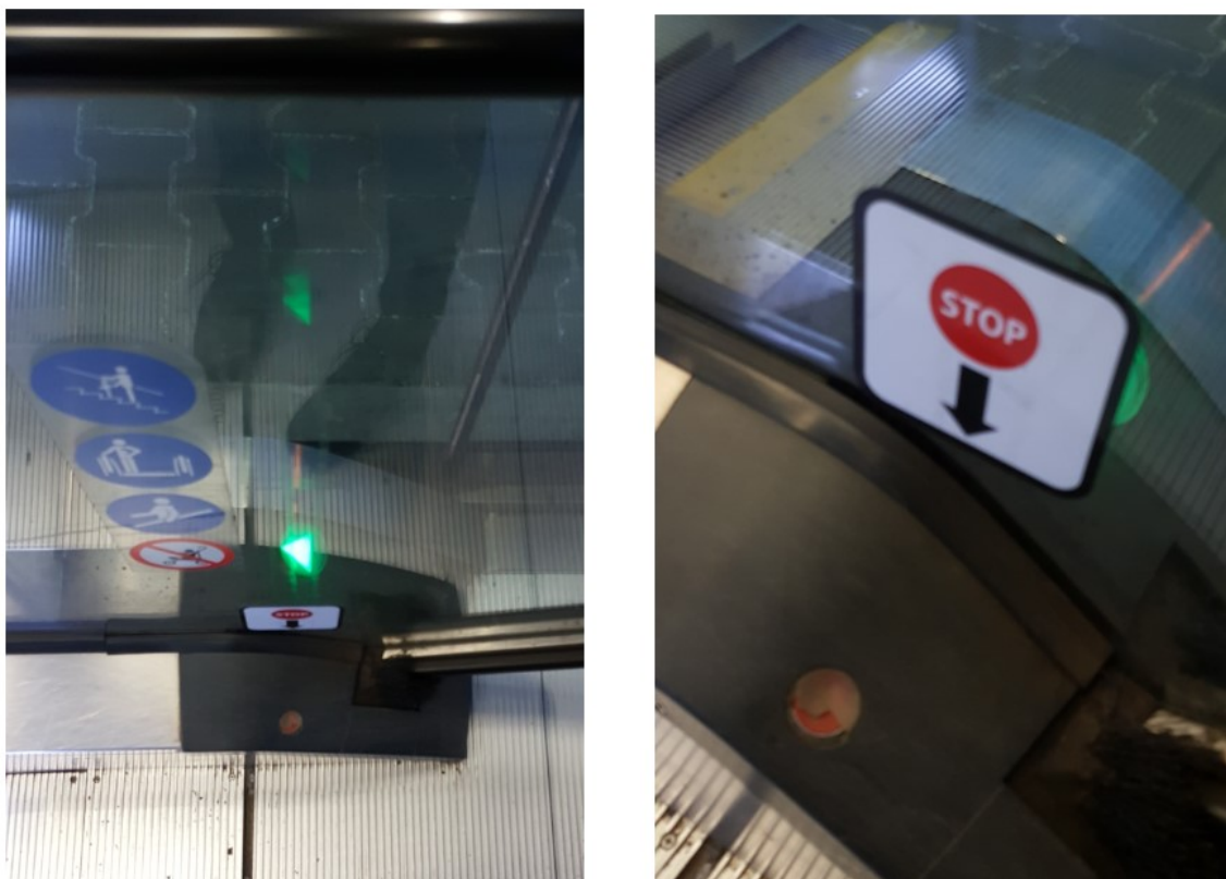
Obr. 13 Eskalátor na únikové cestě [autor]
