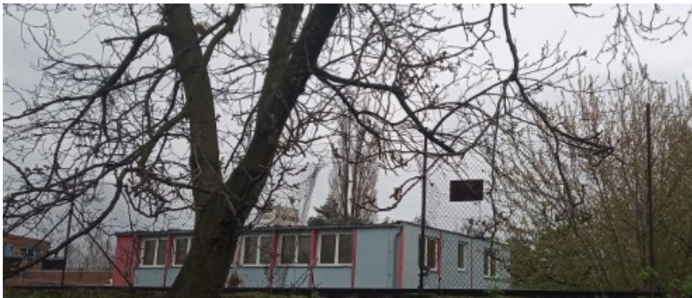
Obr. 28. Narušená obvodová ochrana areálu (Zdroj: vlastní)
