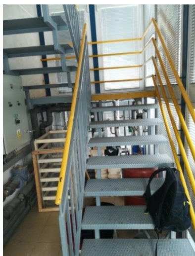
Obrázek 11 – Překážející předmět na schodišti u evakuačního východu
