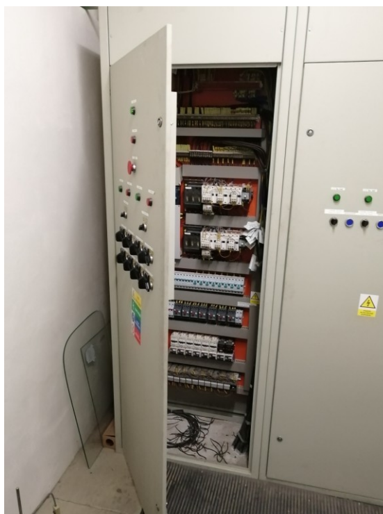
Obrázek 7 - Nezabezpečená elektrická rozvodná skříň (zdroj: vlastní).
