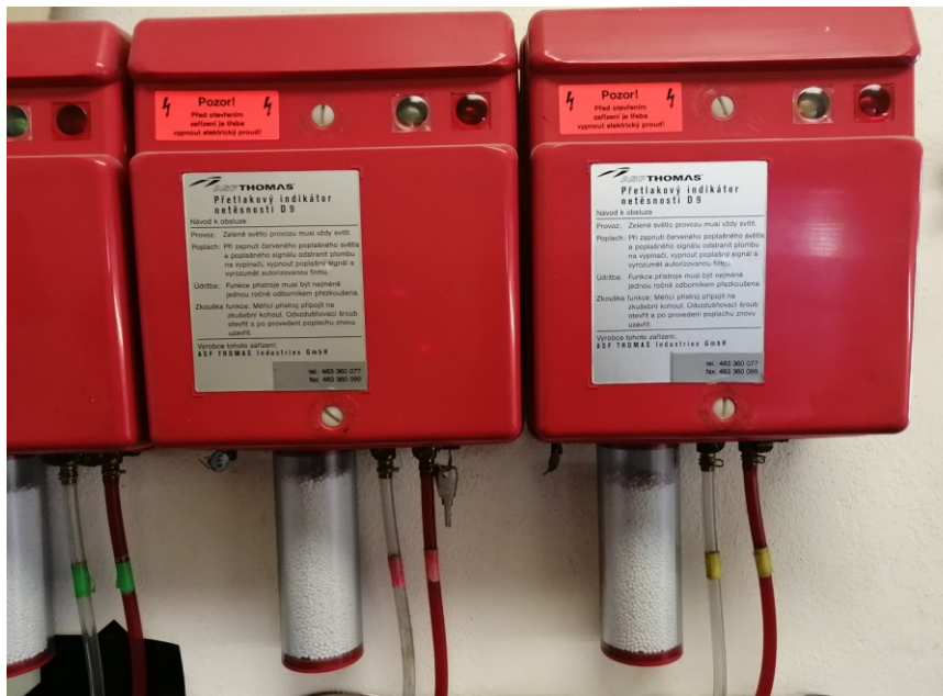
Obrázek 3 - Přetlakový indikátor netěsnosti typu D9, instalovaný u popisovaného objektu (zdroj: vlastní).
