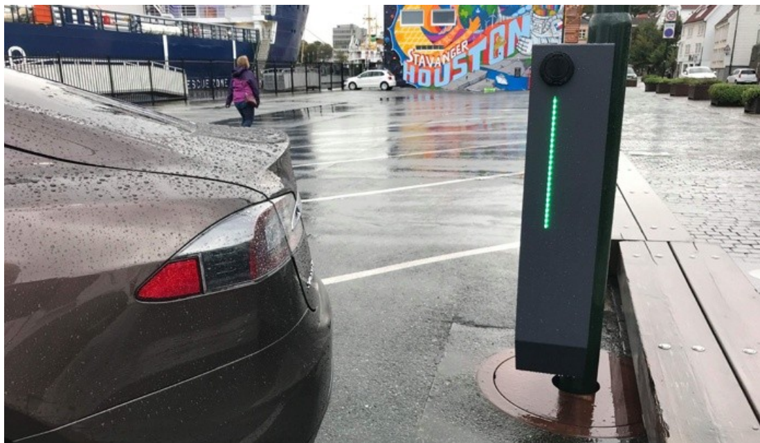
Obrázek 20 – Nabíjecí stanice pro elektromobily (Zdroj: město Stavanger)
