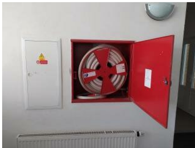
Obrázek 19 - Hlavní jistič (vlevo) a hydrantové zařízení (vpravo) [vlastní]
