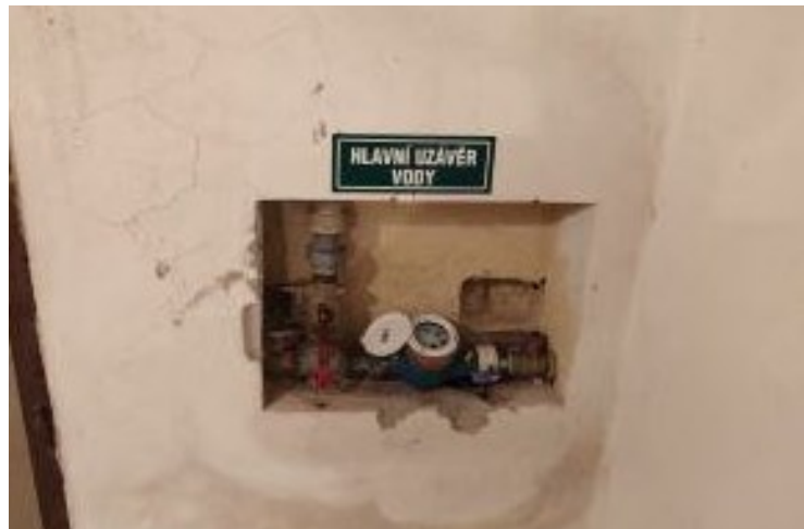
Obrázek 15 - Hlavní uzavěr vody [vlastní]
