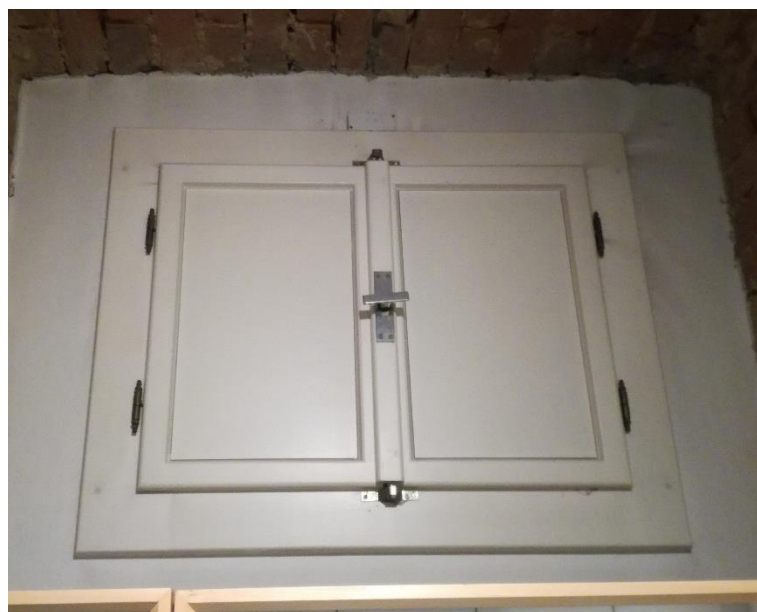
Obr. 11 - Okno z vnitřního prostoru s otřesovým detektorem
