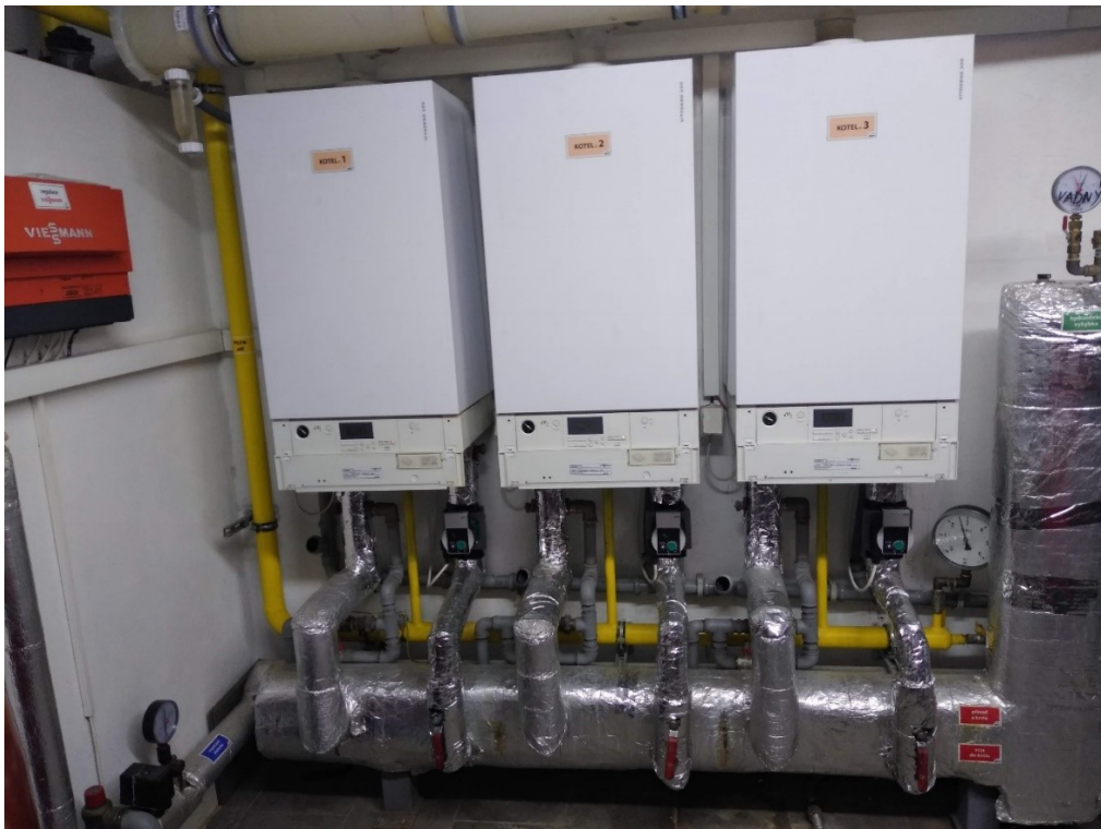
Obrázek 9 - Pohled na kotle. Zdroj: [Vlastní]
