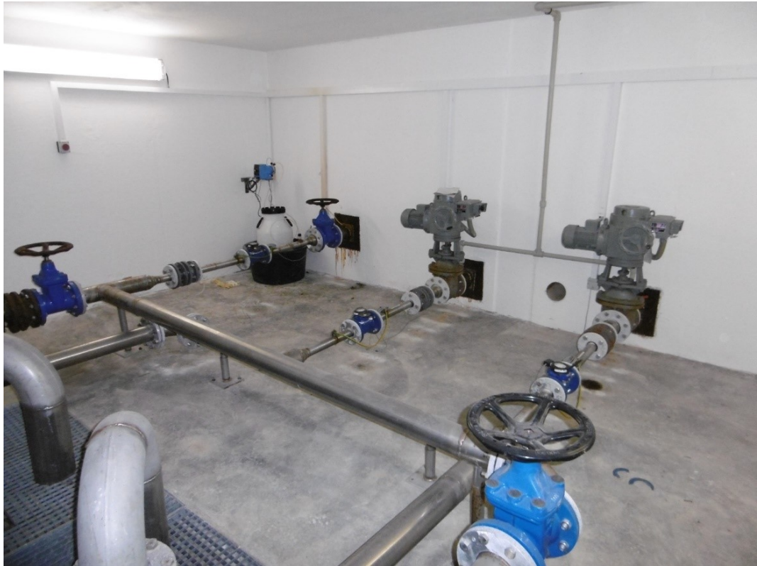
Obr. 7. Rozvodné potrubí vodojemu Štarnov
