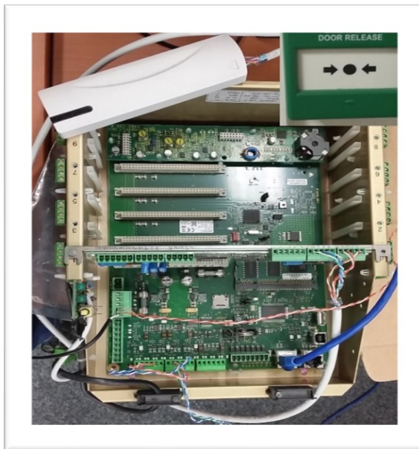
Obr. 5 Řídicí ústředna SKV osazená prvky
