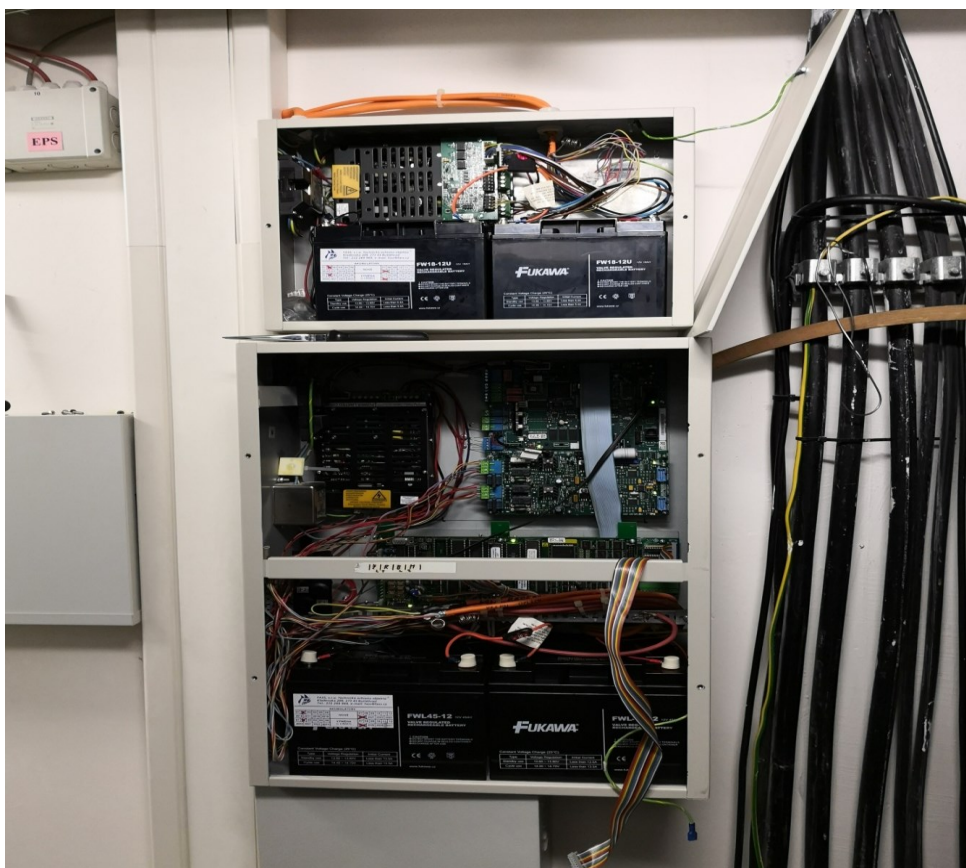
Obr. 1 Ústředna EPS a externí zdroj napájení [zdroj: vlastní]
