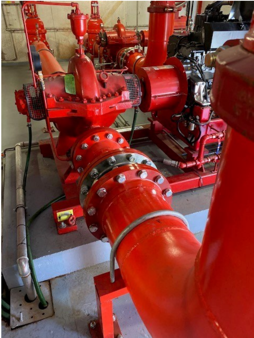
Obr. 9. Vodní čerpadlo s pohonem diesel motoru [zdroj: vlastní]
