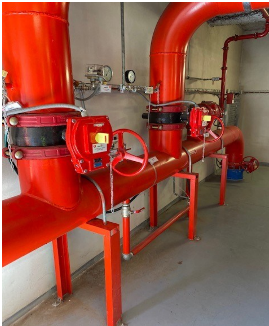
Obr. 8. Ventilová stanice SHZ [zdroj: vlastní]
