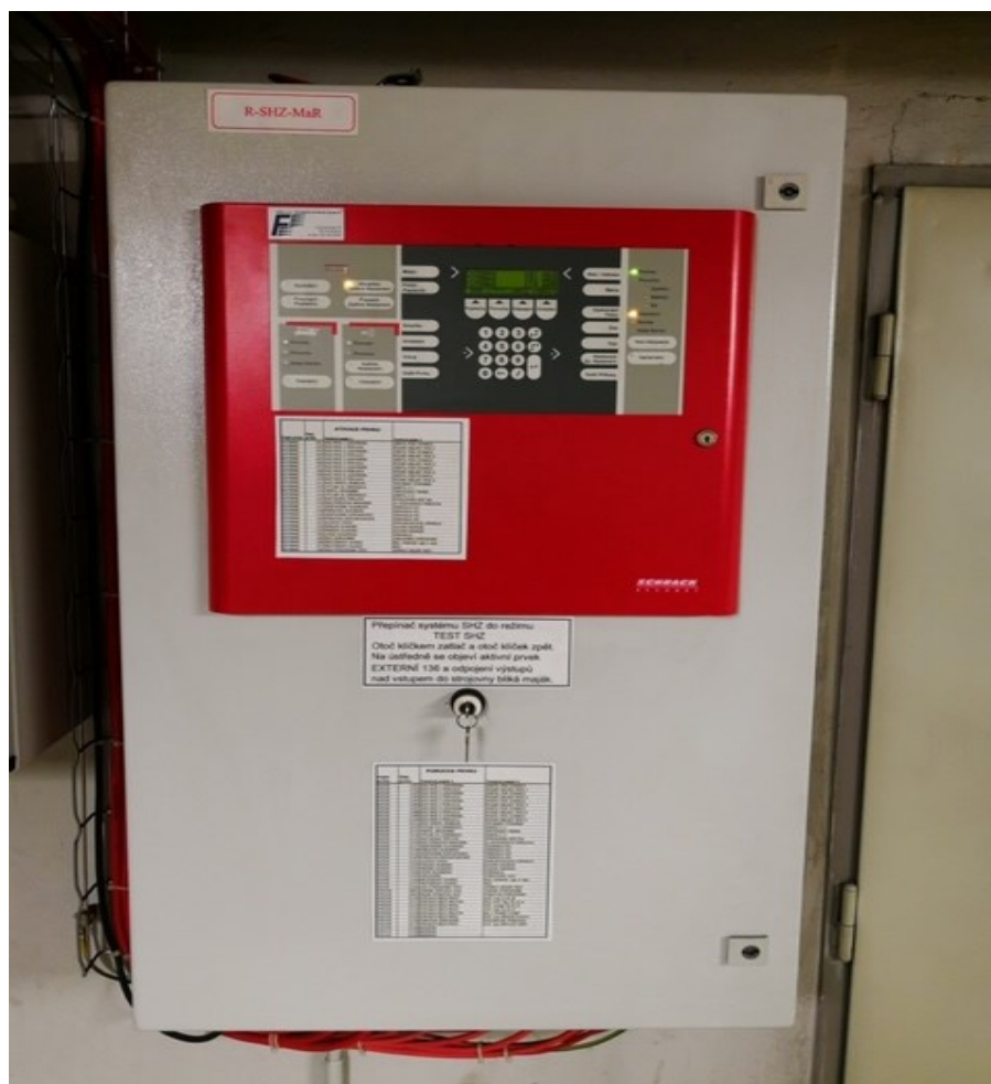
Obr. 10. Monitorovací ústředna systému SHZ [zdroj: vlastní]
