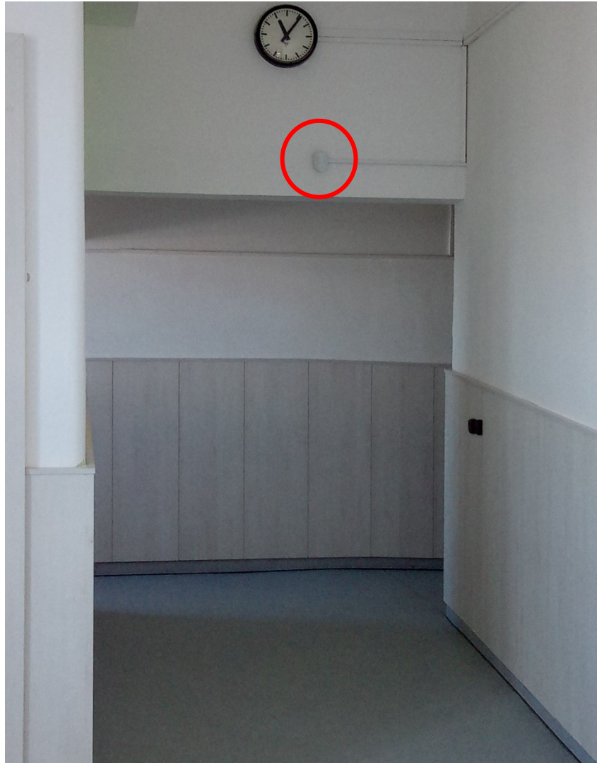
Obr. 14 – PIR detektor v přízemní chodbě druhé budovy [vlastní]
