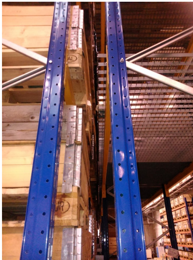
Obr. 16 Stav před instalací bezpečnostních sítí [vlastní]
