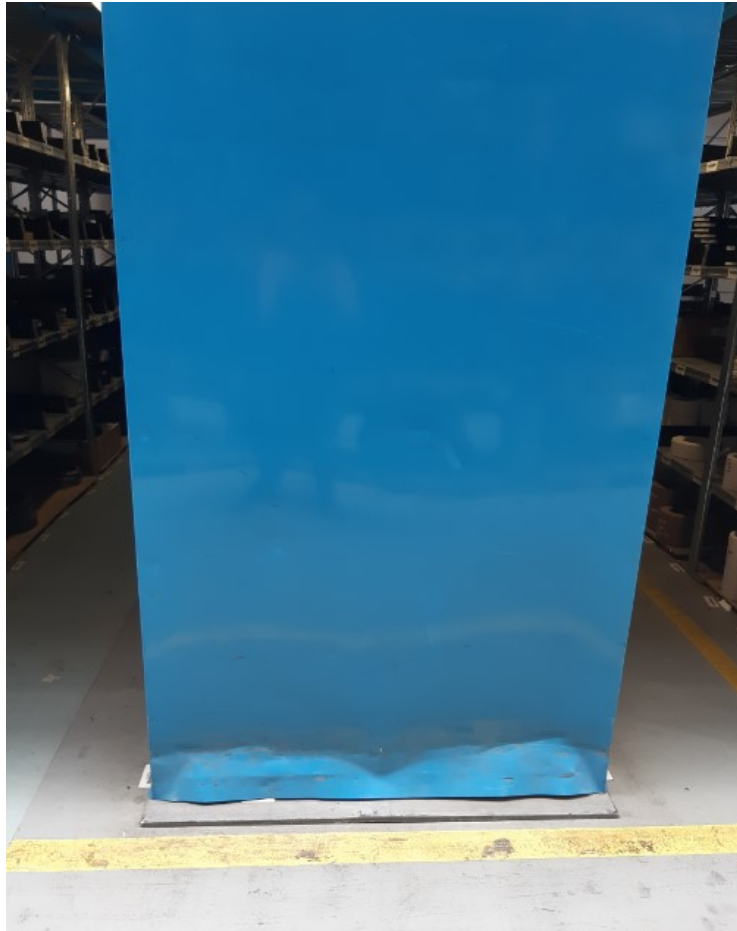
Obr. 9 Poškozený mezanin od VZV v důsledku nevyhovující šíře uliček [vlastní]
