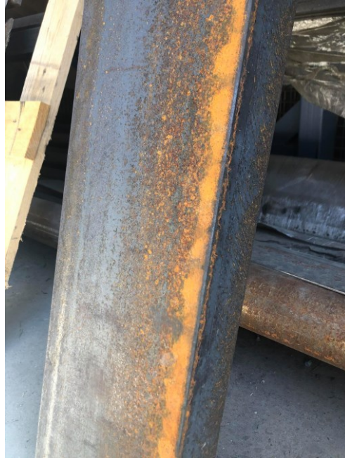
Obrázek 33 Koroze materiálu 1 (vlastní zdroj)
