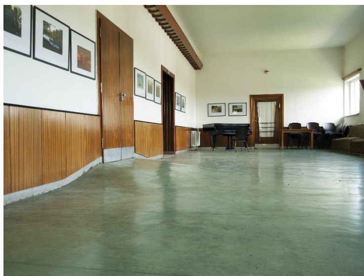
Obr. 37: Přísálí - Částečná sklonitost podlahy
