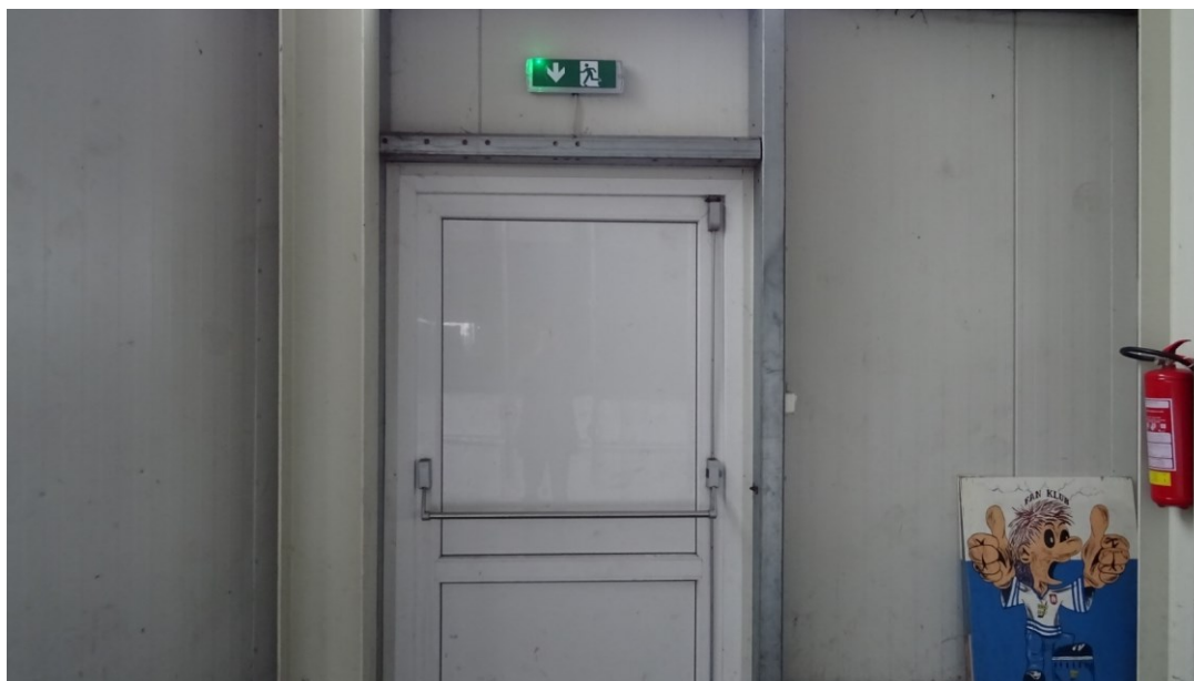
Obrázek 9 protipožární dveře (zdroj vlastní)
