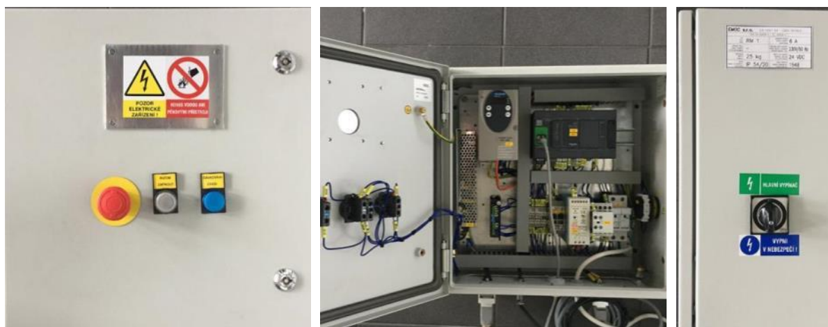
Obrázek 25 - Řídící jednotka TSSC zařízení. Vlevo pohled na přední stranu, uprostřed kontrolní systémy a elektroinstalace, vpravo hlavní vypínač.
