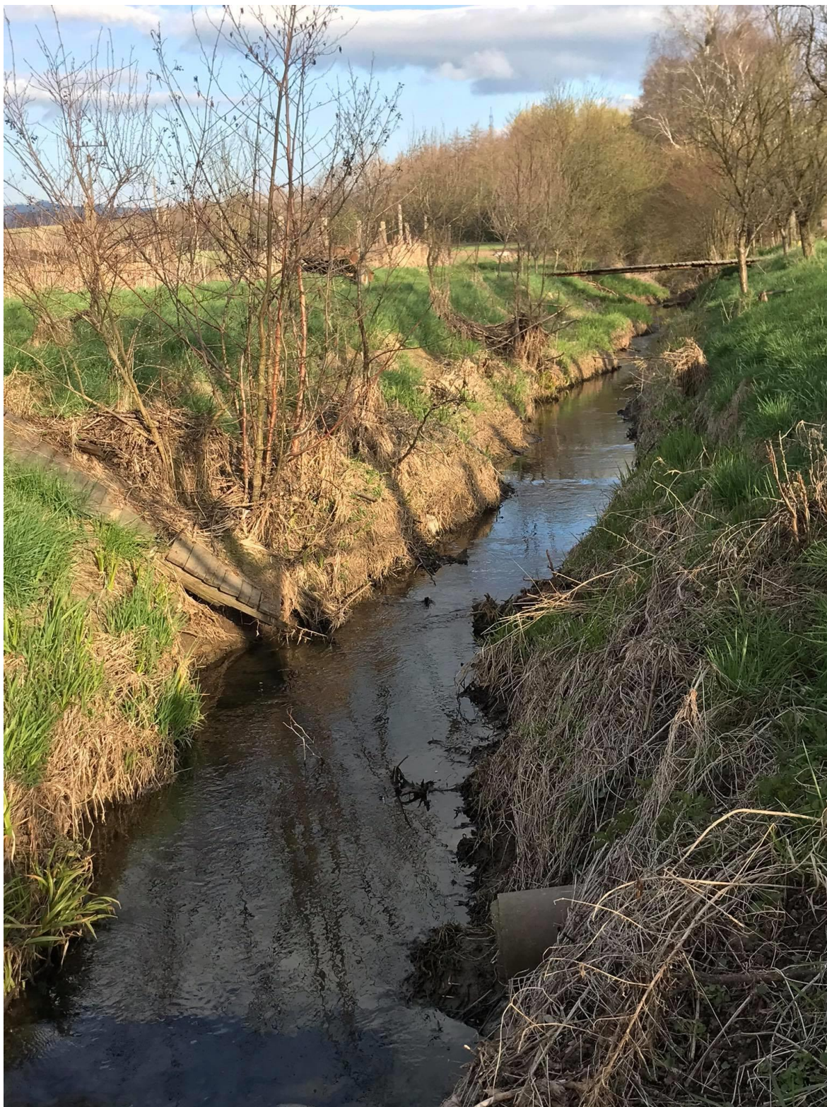
Obr. 12 – Spadlý most v korytu (vlastní)
