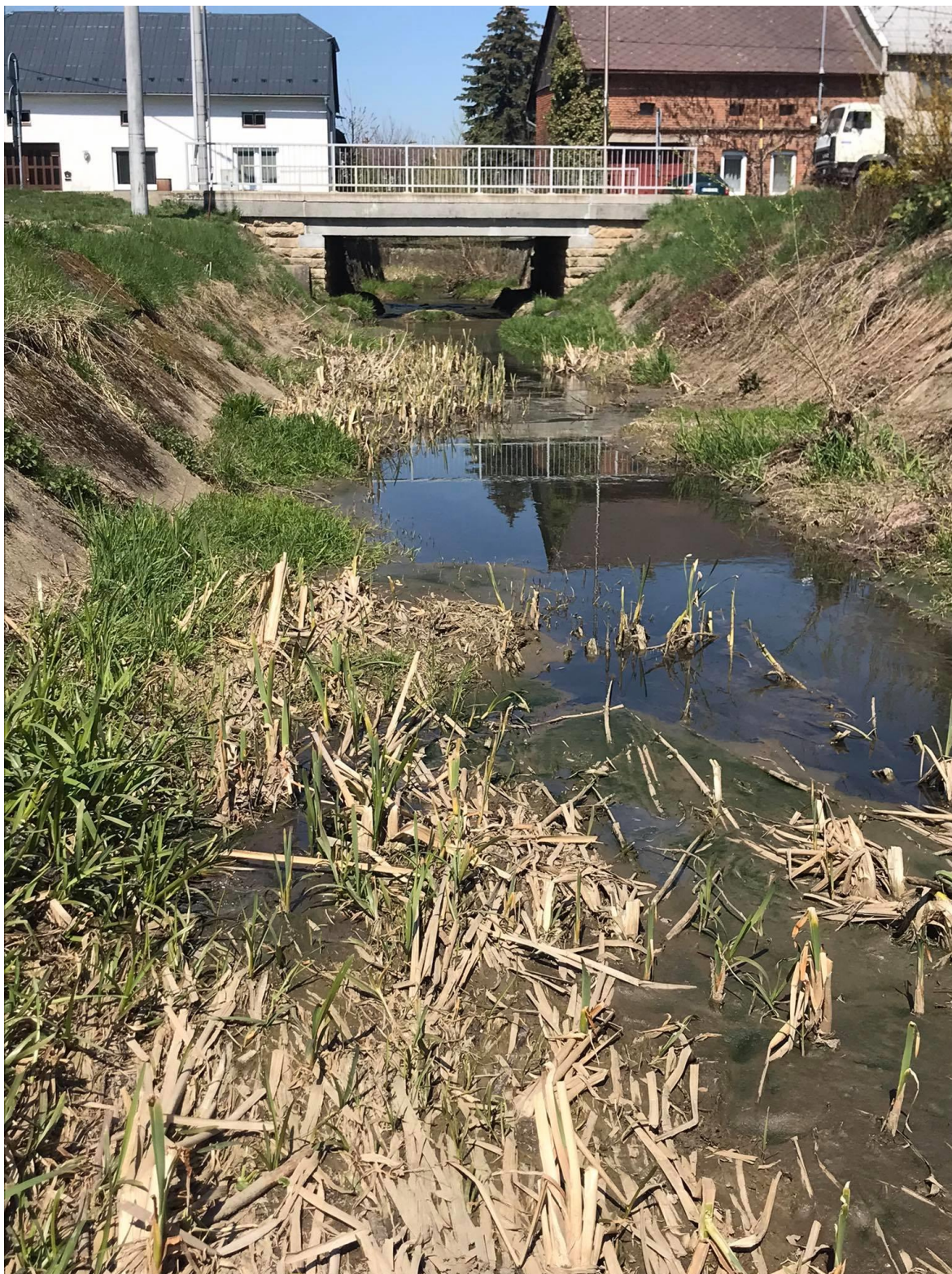
Obr. 21 – Zanesení koryta v ulici Hlavní (vlastní)
