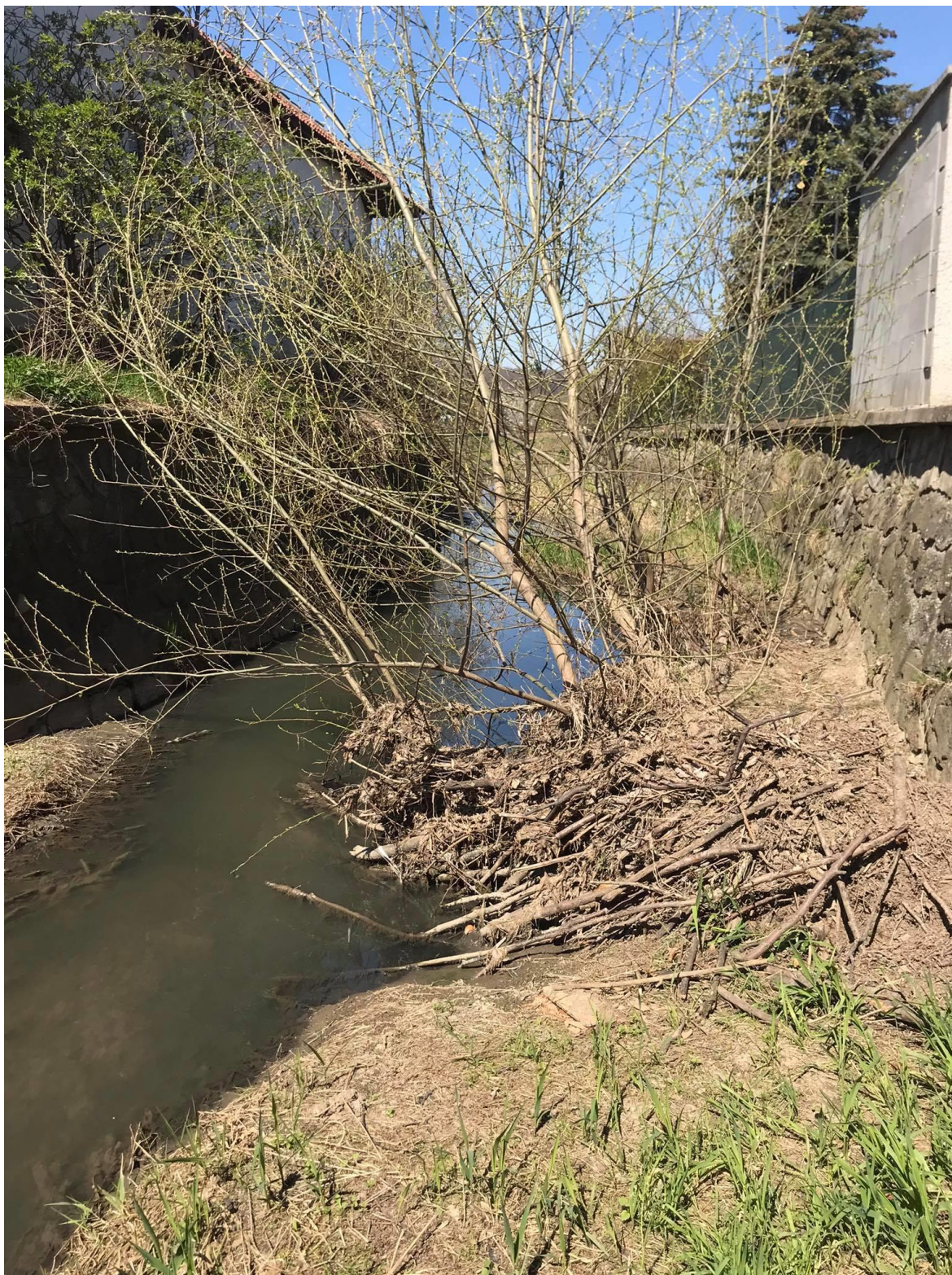
Obr. 22 – Naplaveniny v betonovém korytu potoka (vlastní)
