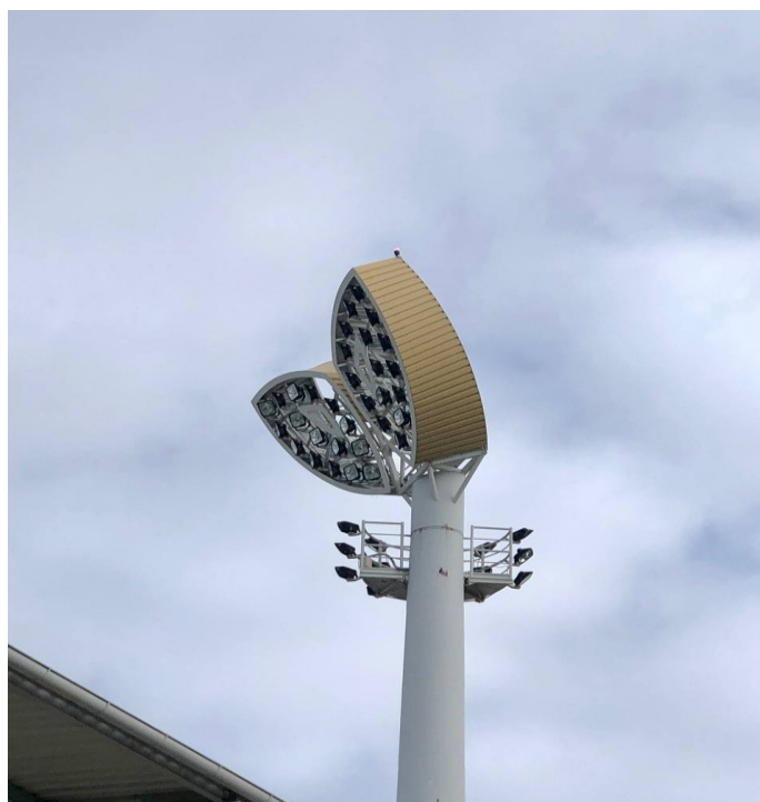
Obrázek 29 – Osvětlení stadionu (Zdroj: vlastní)
