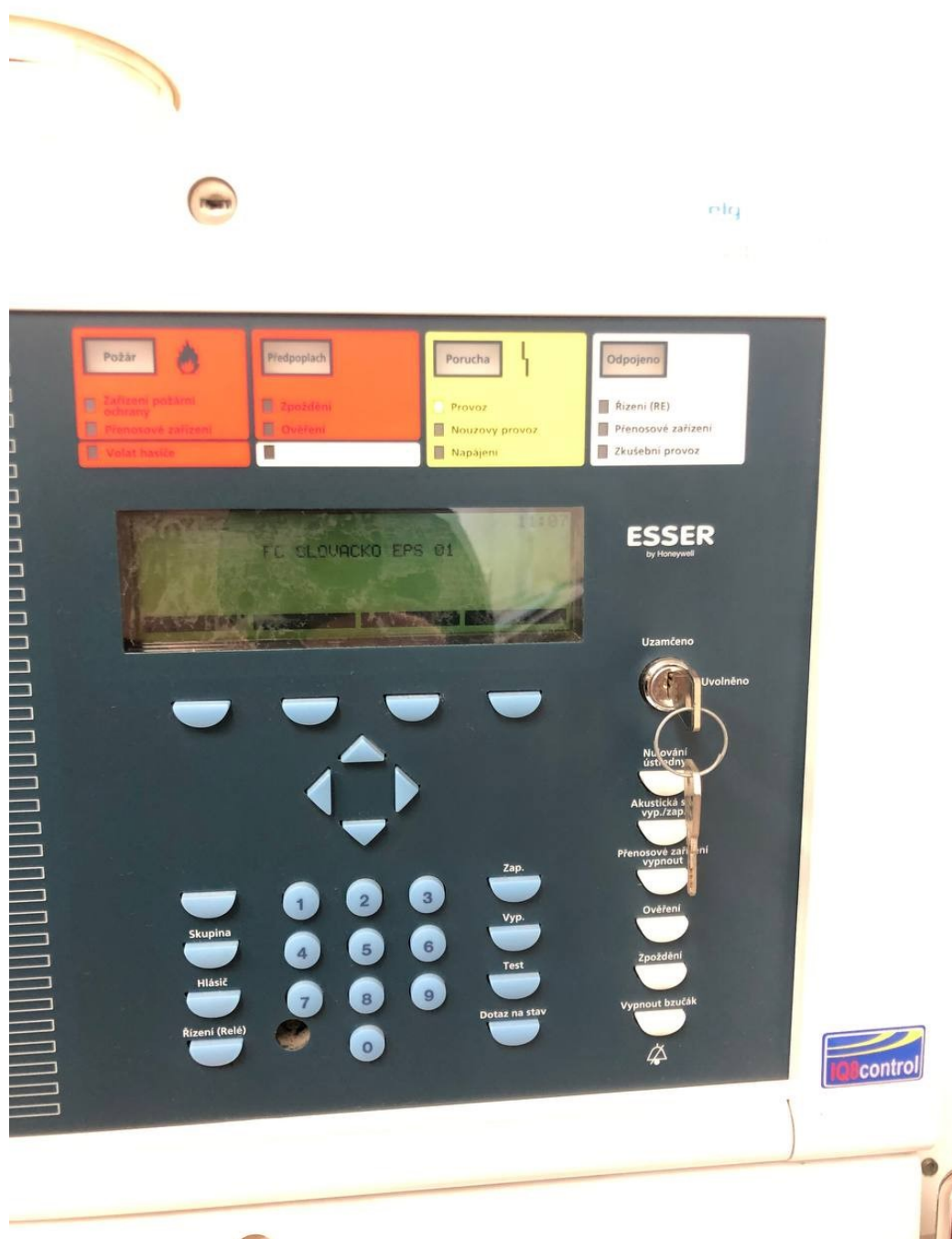
Obrázek 35 – Poplachový zabezpečovací systém signalizace (Zdroj: vlastní)
