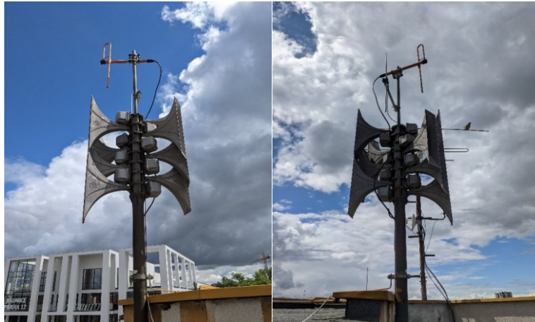
Obrázek 4 Elektronická siréna na staré budově ÚMČ Praha 12 (zdroj: Autor)
