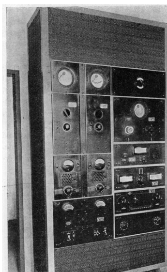
Skříň zesilovačů s kontrolními, měřicími a regulačními přístroji zvukové aparatury Tobis-Klangfilm
