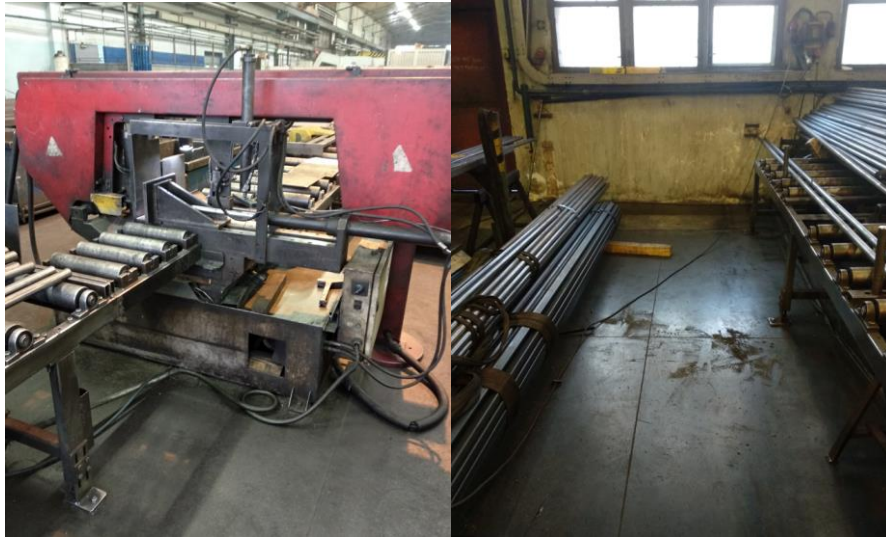
Obrázek 26 – kabely volně v pracovním prostoru (vlastní zpracování)
