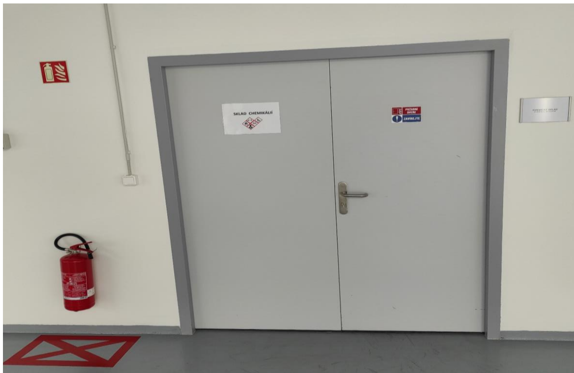
Obrázek 14-Protipožární dveře chemického skladu s hasicím přístrojem (Zdroj vlastní)
