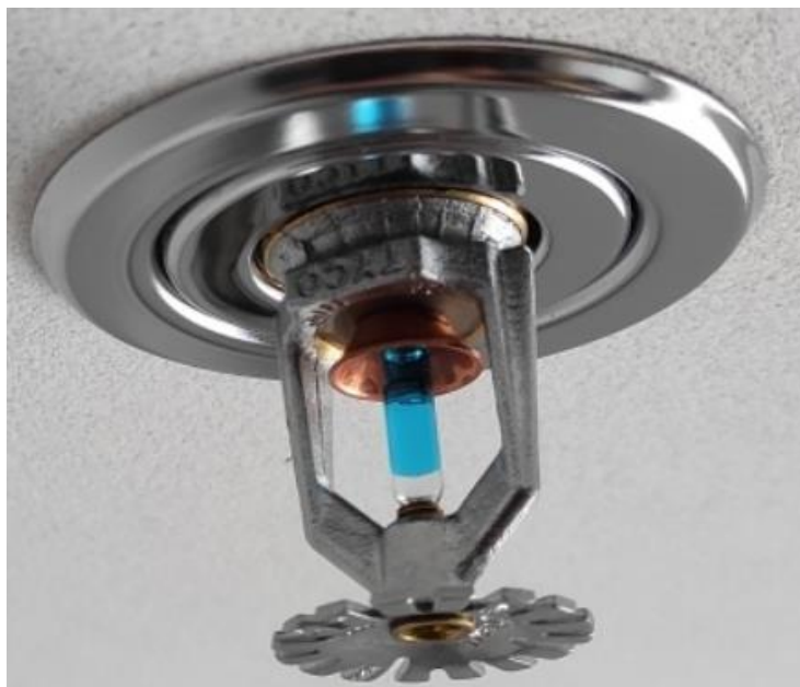
Obrázek 13-Sprinklerová hlavice s modrou kapalinou (Zdroj vlastní)
