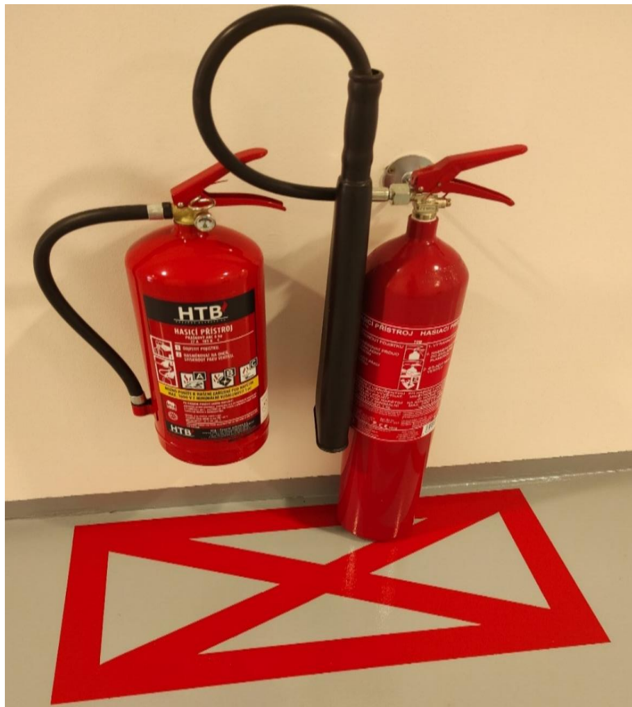
Obrázek 17-Práškovací hasičího přístroj s CO 2 hasičím přístrojem na chodbě MAT LAB (Zdroj vlastní)
