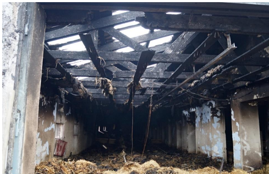
Obrázek 4 Stav haly po požáru s rozebranou střechou (Götzová, 2017)
