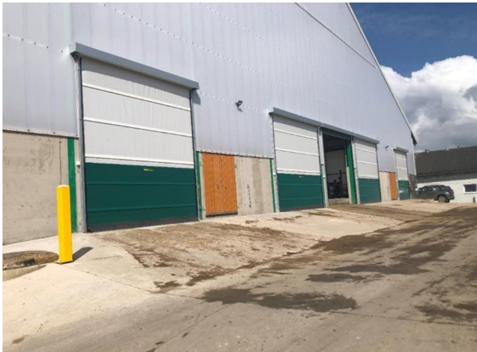
Obrázek 7 Vrata s požárními únikovými dveřmi, stáj I. (zdroj vlastní, 2023)
