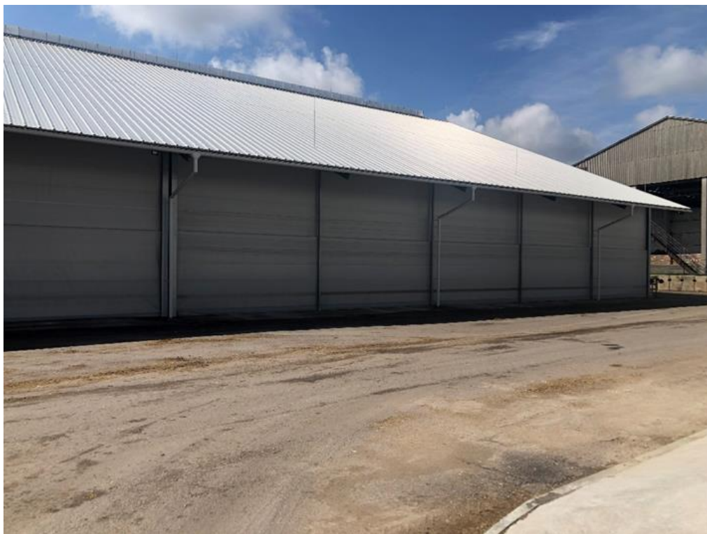
Obrázek 17 Vytahovací plachta na záložní el. zdroj , stáj III.
