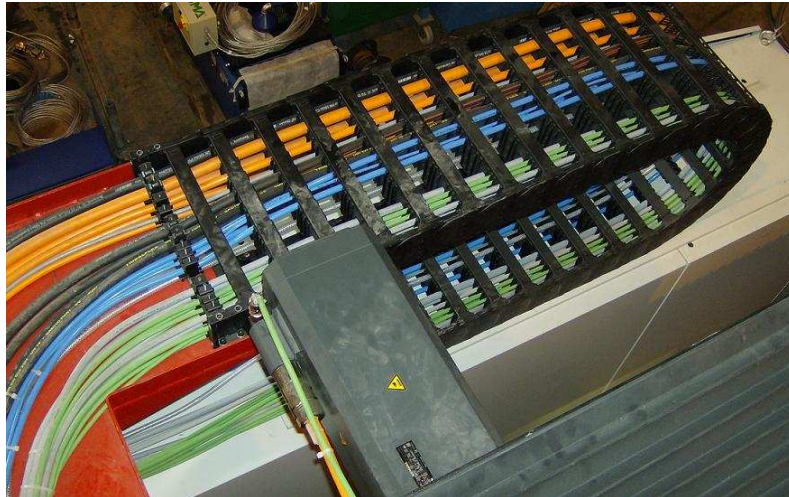
Obr. 18. Kabelový řetěz na obráběcím stroji
