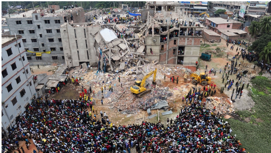
Obrázek 3 – Sesunutí budovy Rana Plaza v Bangladéši roku 2013 (zdroj: Why Won't We Learn from the Survivors of the Rana Plaza Disaster?, 2013)
