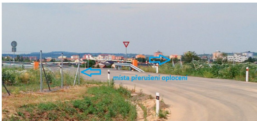
Obrázek 13 Přerušené oplocení na km 33,3 dálnice D55 (Seznam.cz, a.s., 2024)
