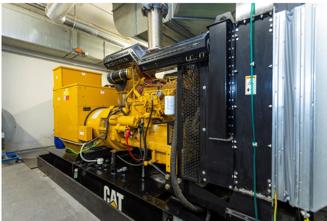
Obrázek 13 Náhradní zdroj elektrické energie pro budovu kraje (vlastní).
