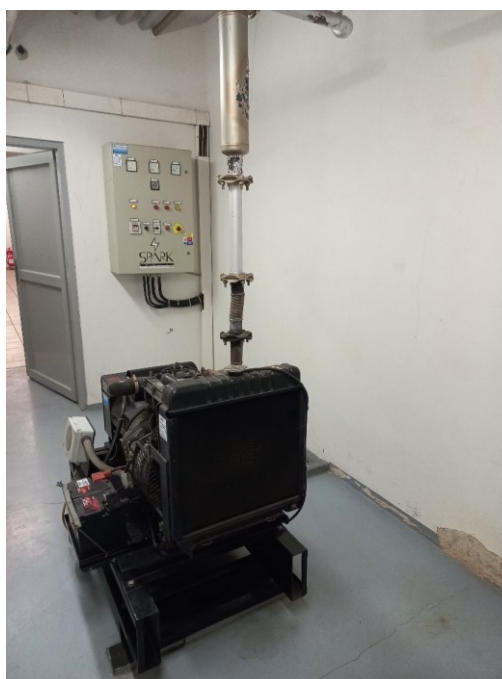
Obrázek 15 Náhradní zdroj elektrické energie (vlastní).
