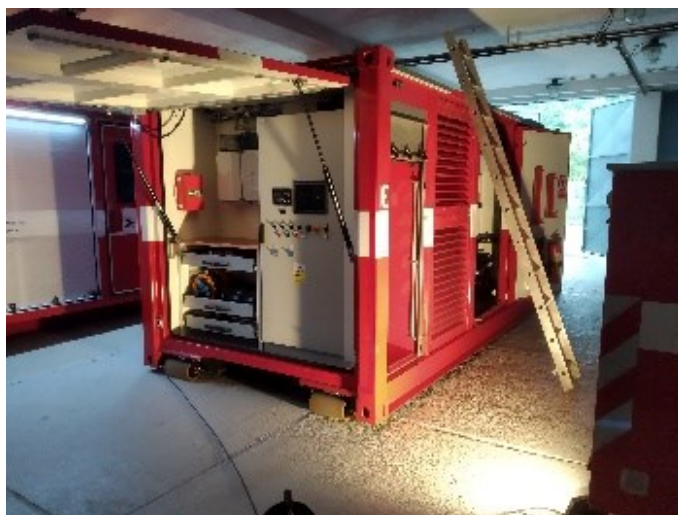
Obrázek 12 Kontejnerová elektrocentrála 200 kW (vlastní).
