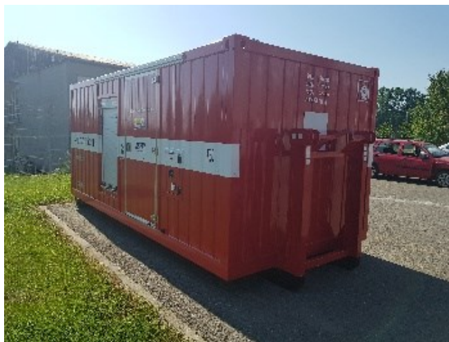
Obrázek 11 Kontejnerová elektrocentrála 88 kVA (vlastní).
