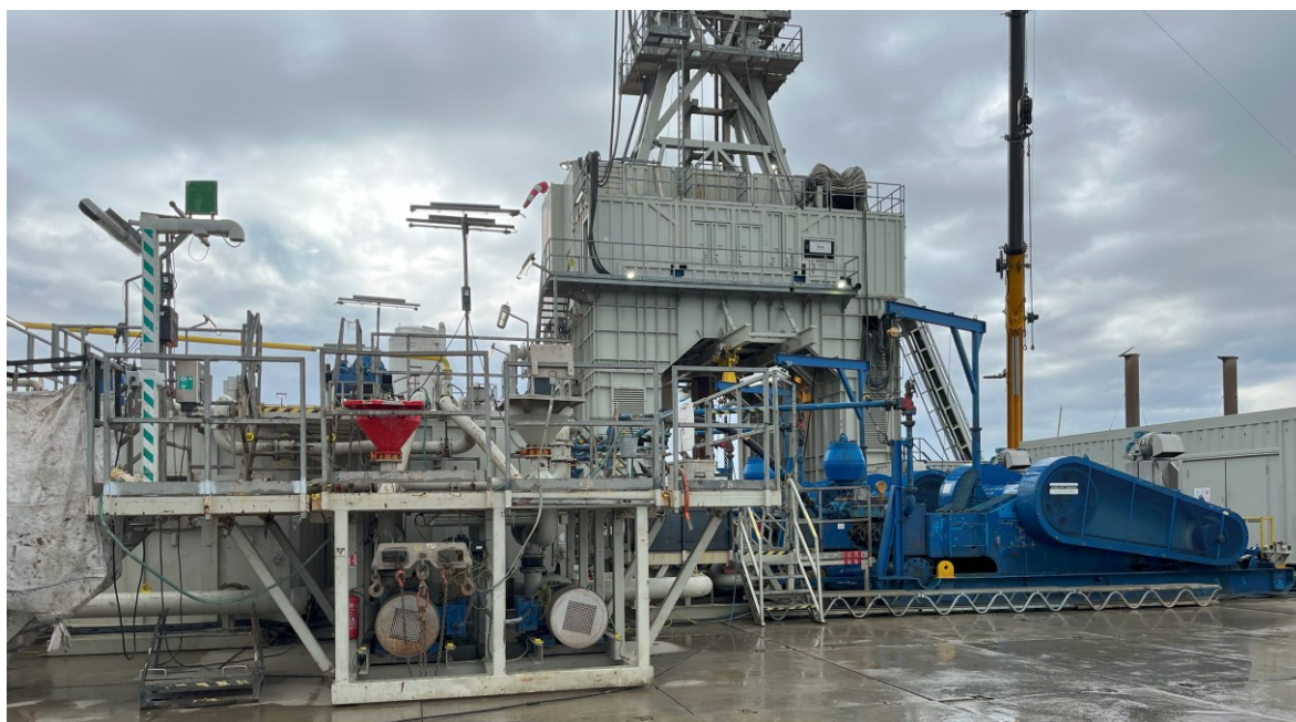
Obrázek 12 - Filtrační zařízení s čerpadly
