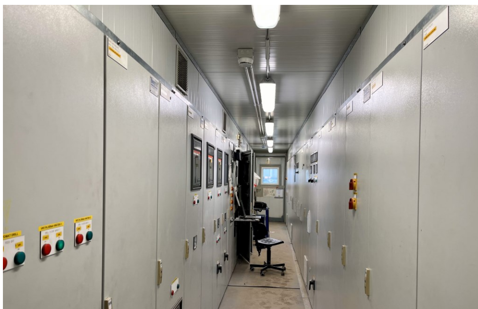
Obrázek 1 - Řídicí místnost výroby elektrické energie
