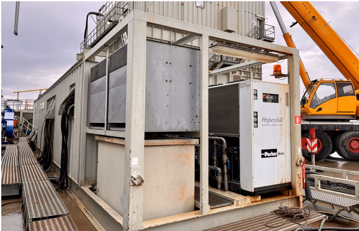
Obrázek 9 - Trafostanice se vstup do řídicí místnosti elektrárny
