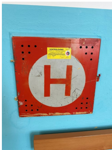
Obrázek 12 – Umístění nástěnného hydrantu (vlastní)
