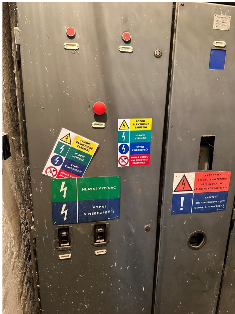
Obrázek 9 – Hlavní vypínač elektrického proudu (vlastní)
