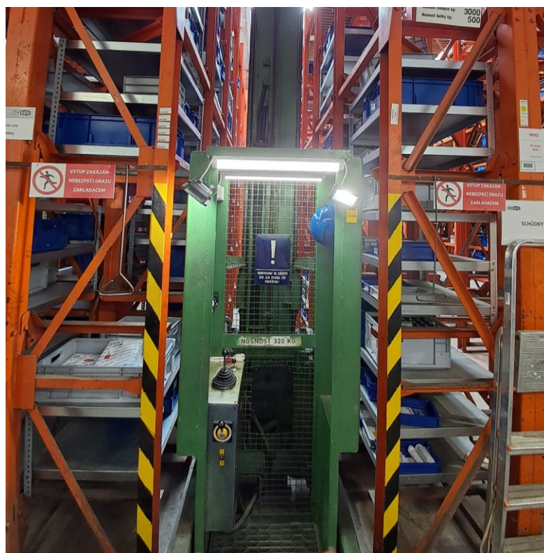
Obrázek 19 Kabina regálového zakladače Demag (vlastní zpracování)
