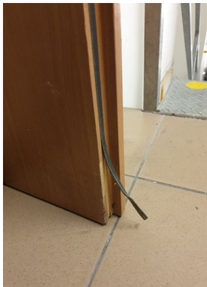
Obrázek 7 - závada požárních dveří administrativa (zdroj vlastní)
