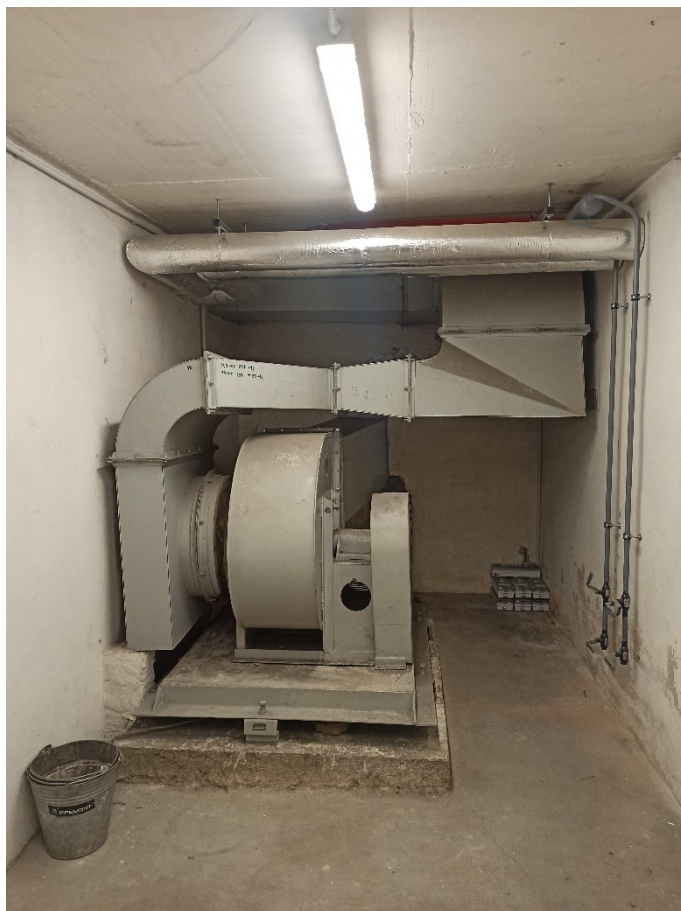
Vzduchotechnické zařízení (Vlastní)
