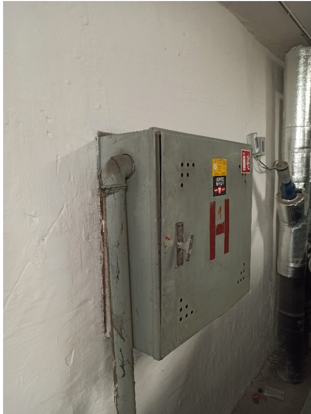
Požární hydrant v prostoru (Vlastní)
