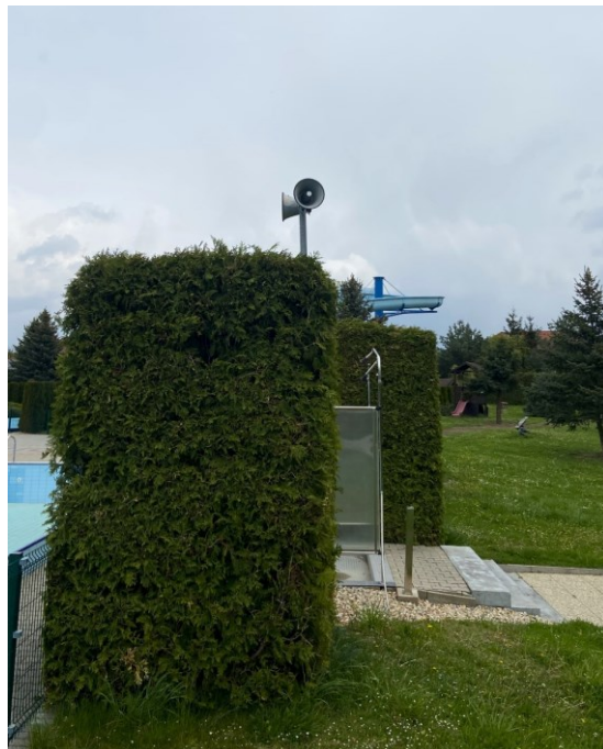
Obrázek 23: Rozhlasový systém na sloupu (vlastní)
