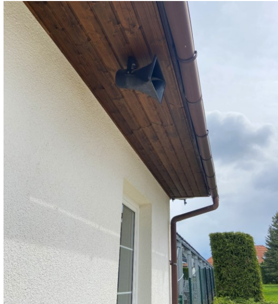
Obrázek 24: Rozhlasový systém na objektu číslo 1 (vlastní)
