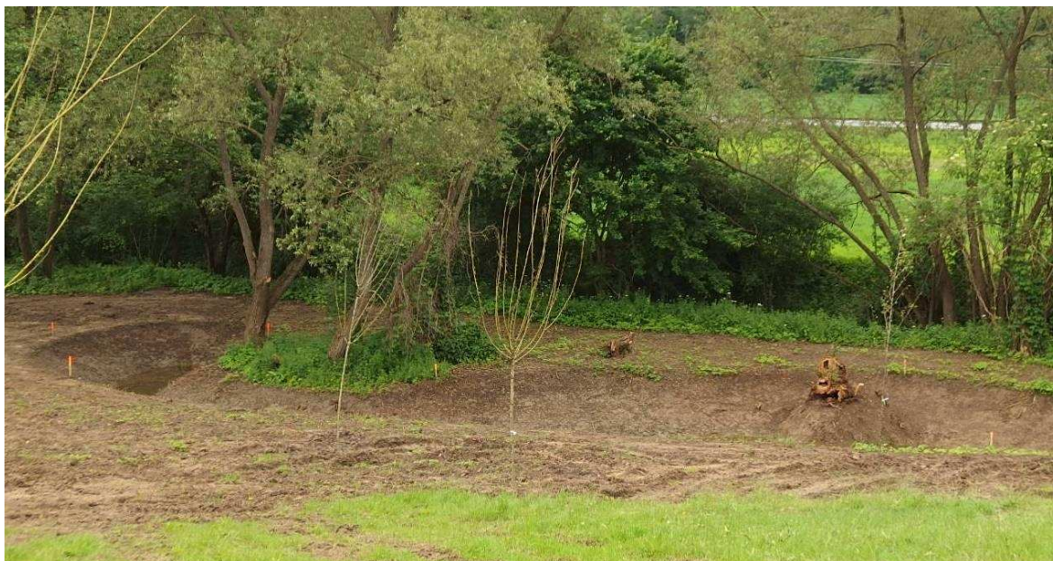
Obrázek 9 Tůň Zákřov (zdroj: Místní strategie adaptace na změnu klimatu města Uherský Brod, 2019)
